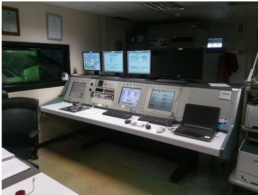
Figura 4.5 - Sala de controlo do banco de ensaios presente na TAP M&E
