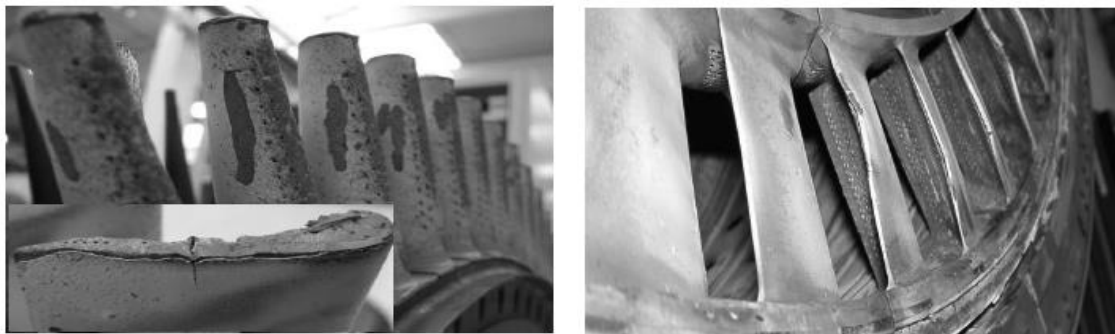
a) Danos nas pás
