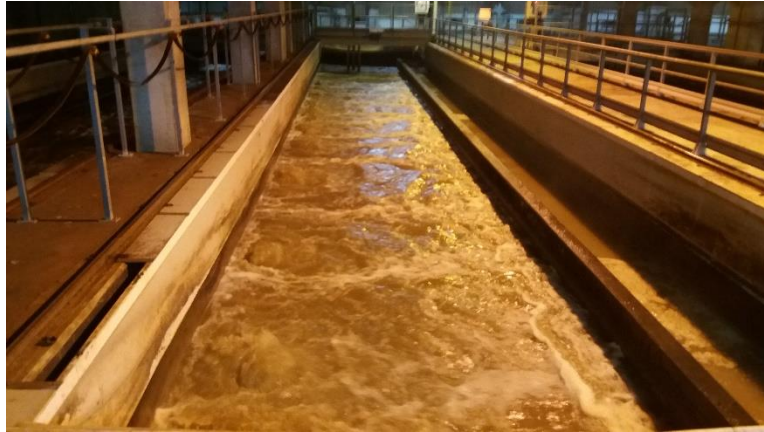
Figura 34 – Desarenador/desengordurador da ETAR de Alcântara
