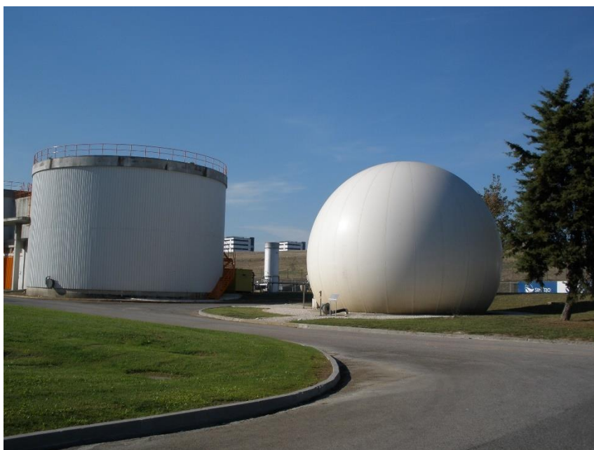
Figura 17 – Reservatório de gás na ETAR de Beirolas
