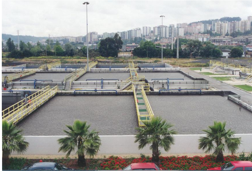
Figura 24 – Tanques de arejamento da ETAR de Frielas
