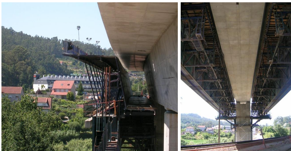
(À Esq.) Figura 3.30 – Aspecto visual lateral da Viga totalmente aberta, (Viaduto 2).
