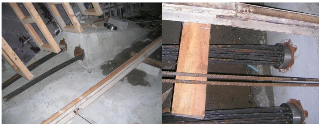
(À Esq.) Figura 3.22 – Armadura de pré-esforço antes de aplicação de tensão, (Viaduto 2). (À Dta.) Figura 3.23 – Armadura de pré-esforço após aplicação de tensão, (Viaduto 2).
