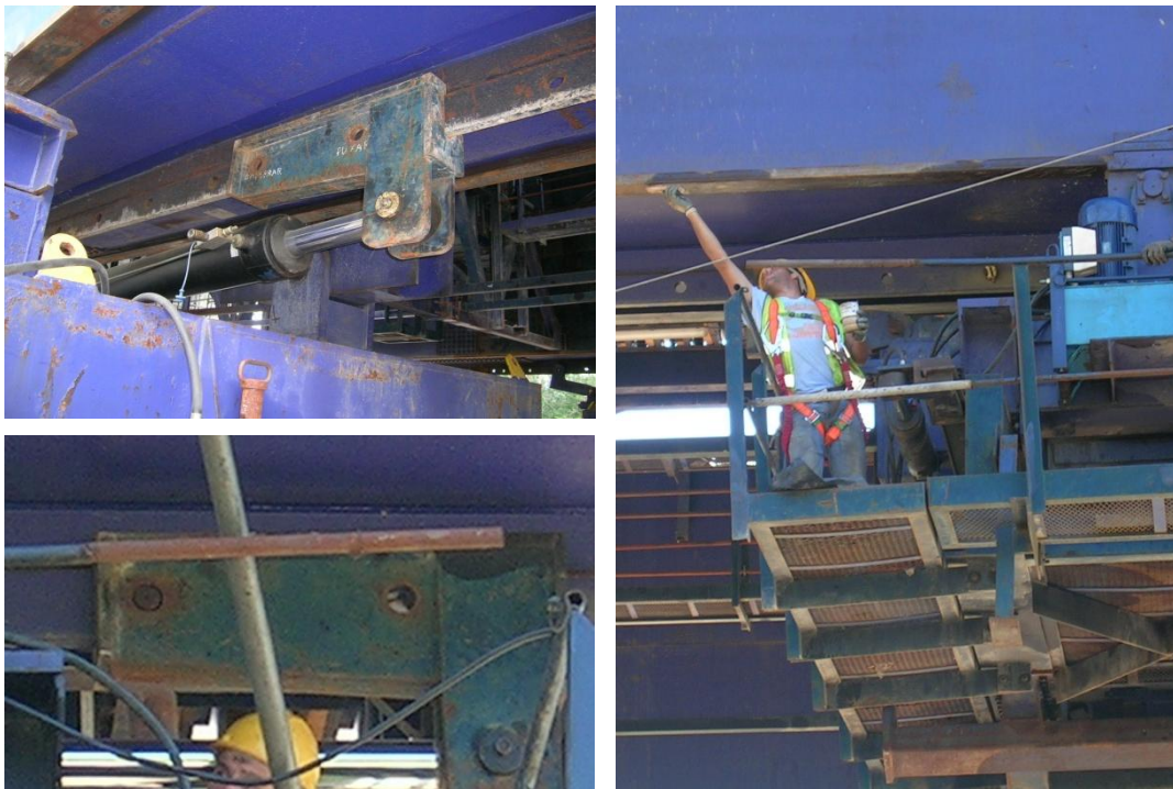
(Cima Esq.) Figura 3.32 – Ligação entre hidráulico e régua de avanço, (Viaduto 2). (Baixo Esq.) Figura 3.33 – Fixação através de ligação pernada, (Viaduto 2). (À Dta.) Figura 3.34 – Espalhamento de massa consistente, (Viaduto 2).
