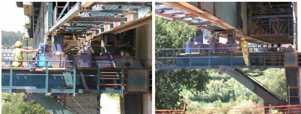
(À Esq.) Figura 3.28 – Início de movimentação transversal, (Viaduto 2).
