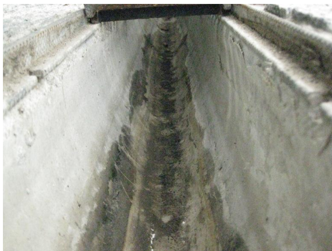
Figura 23 - Caleira de drenagem de águas pluviais- Edifício Sede EDP em Coimbra
