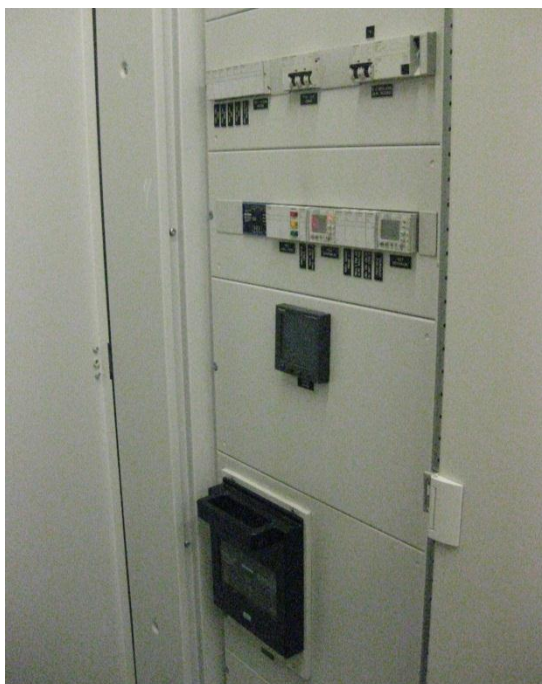
Figura 25 – Quadro eléctrico- Edifício Sede EDP em Coimbra
