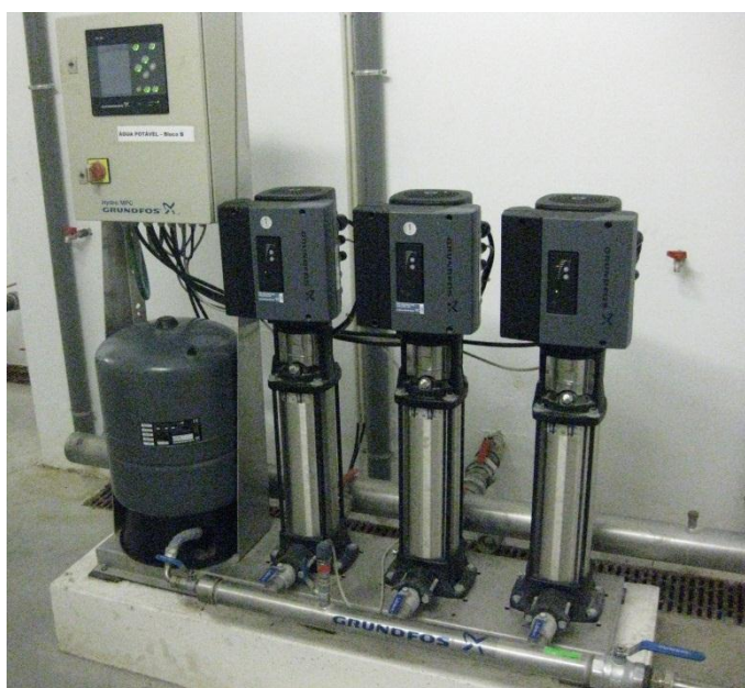
Figura 20 - Sistema Hidropressor – Edifício Principal EDP em Lisboa
