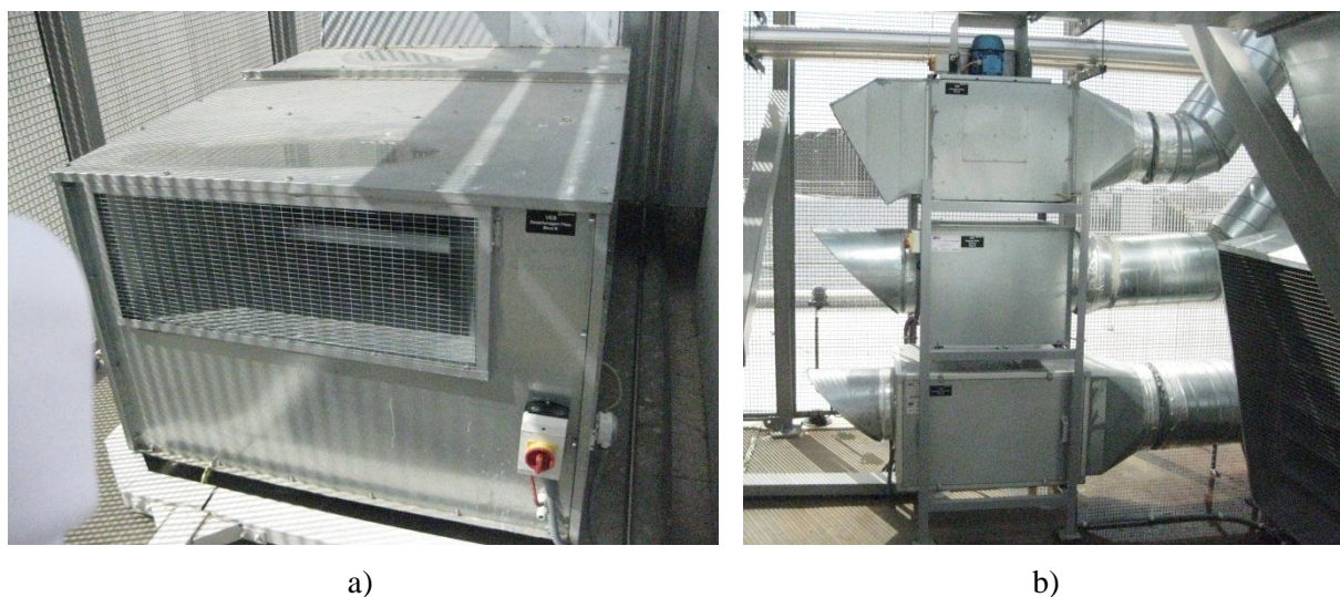
Figura 11 – Ventiladores - Edifício Sede EDP em Coimbra
