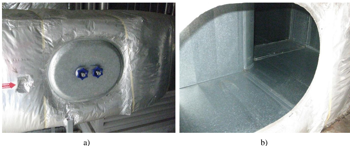
Figura 16 - Conduitas de AVAC - Edifício Sede EDP em Coimbra
