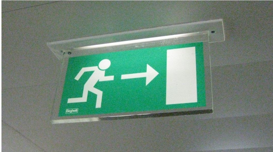
Figura 31 - Iluminação de Emergência – Bloco autónomo - Edifício principal EDP em Lisboa
