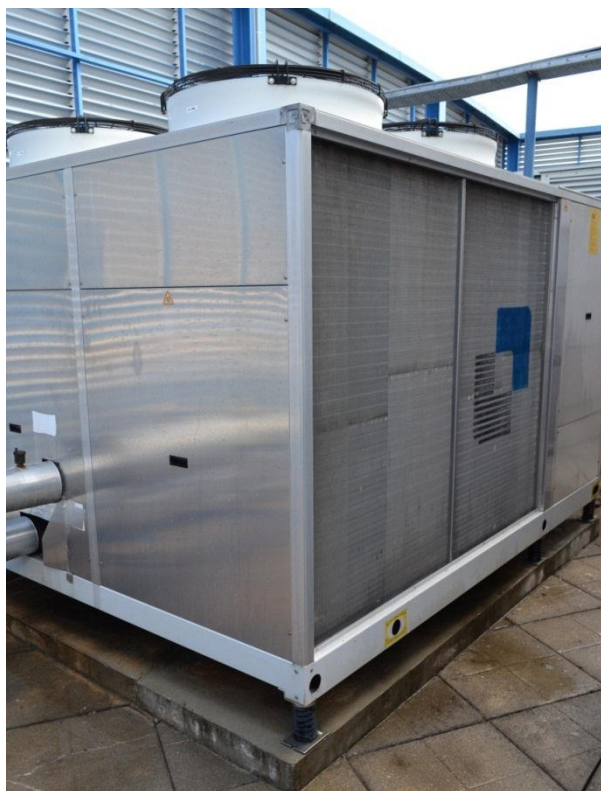
Figura 7 - "Chiller" - Edifício Sede EDP em Coimbra
