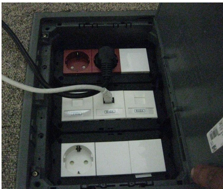
Figura 26 - Tomadas de energia e rede - Edifício Sede EDP em Coimbra
