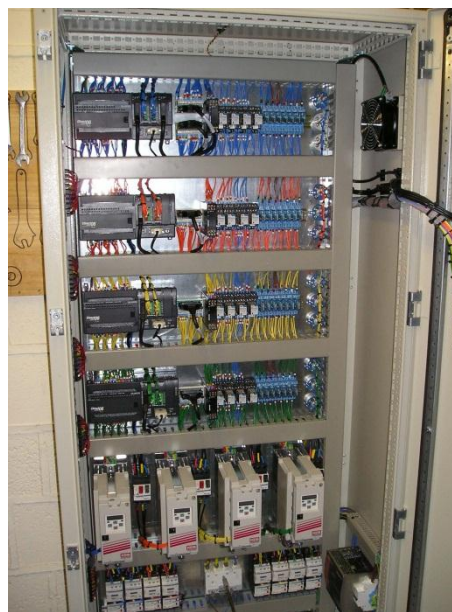
Figura 29 - Disjuntores e contadores de um quadro eléctrico
