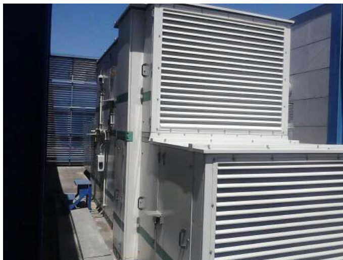
Figura 8 – UTA - Edifício Sede EDP em Coimbra
