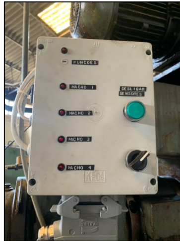
Figura 67 – Quadro elétrico com sensores.
