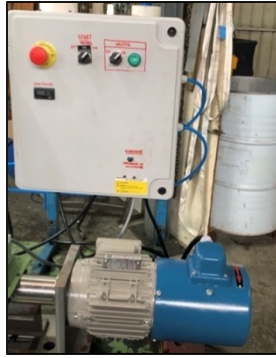
Figura 35- Motor elétrico e respetivo quadro elétrico.
