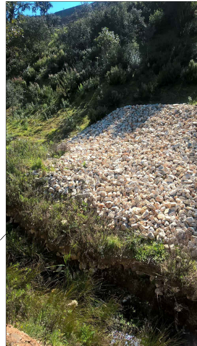
FOTO 3 - MASCARA DRENANTE LOCALIZADA NO PÉ DO TALUDE DE ATERRO
