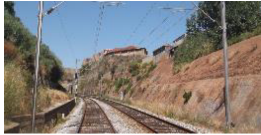
“Linha do Norte, Inspeção de Talude/Observação de zona a intervirer – Sistema de Drenagem”
