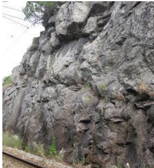
“Linha da Beira Baixa, Troço Abrantes – Guarda – Inspeção de Talude/Observação de zona a intervirer”
