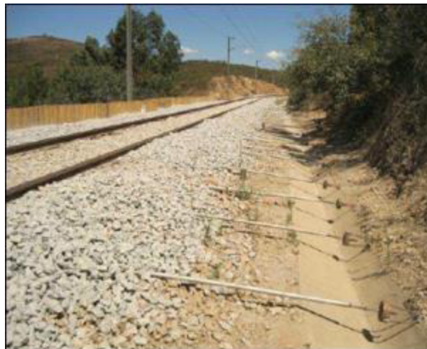
Figura 5-5 – Solução Mitigadora – Tirantes de cordão de aço de alta resistência, IPE, S.A. (2015)
