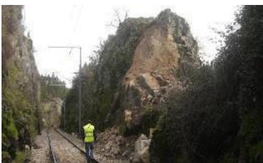
“Linha da Beira Baixa, Troço Abrantes – Guarda – Inspeção de Talude/Observação de zona a intervirer”
