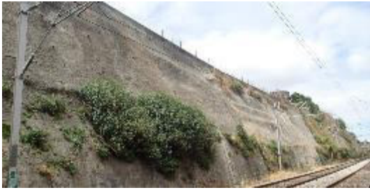
“Linha do Norte, Inspeção de Talude/Observação de zona a intervirer – Remoção de Vegetação”
