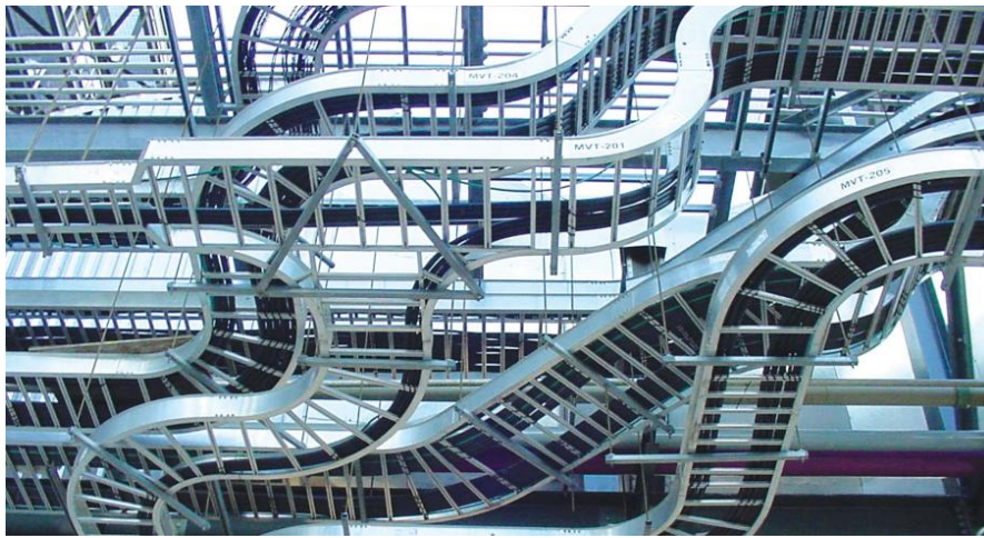
Figura 3.3 - Exemplo de caminho de cabos metálico.
