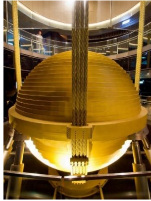
Figura 5.3 - Amortecimento de massa sintonizada instalado no arranha-céus Taipei 101 (EngenhariaCivil.com, 2017)
