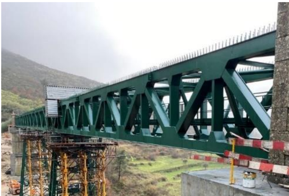
Figura 6.3 - Viga principal mista da Ponte de Gogos da Linha da Beira Baixa
