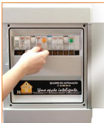
Figura 17 - Quadro de automação
