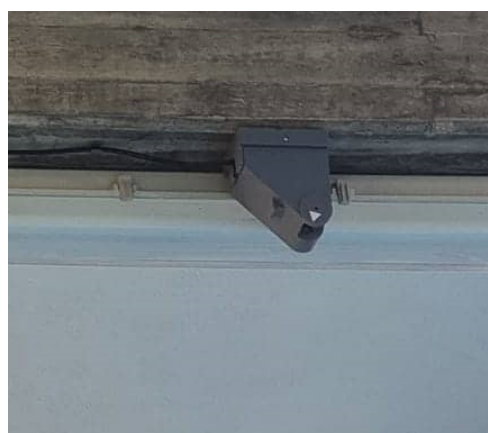
(b) Câmera e servo instalados no teto da piscina
