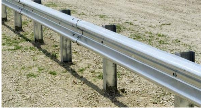
Figura 3.3 – Barreira Metálica Simples
