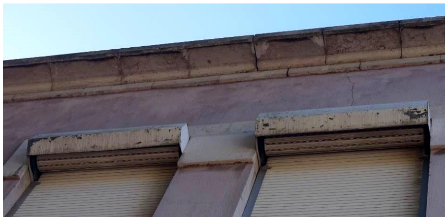
Figura 54: Infiltração generalizada do revestimento sob a cornija do edifício (Fonte: Autor, 2016)
