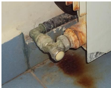
Figura 92: Oxidação da tubagem do radiador na divisão n.º 11 do piso 0 (Fonte: Autor, 2016)
