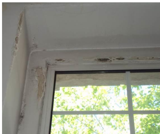
Figura 84: Descolamento e destacamento do revestimento proveniente da humidade (Fonte: Autor, 2016)
