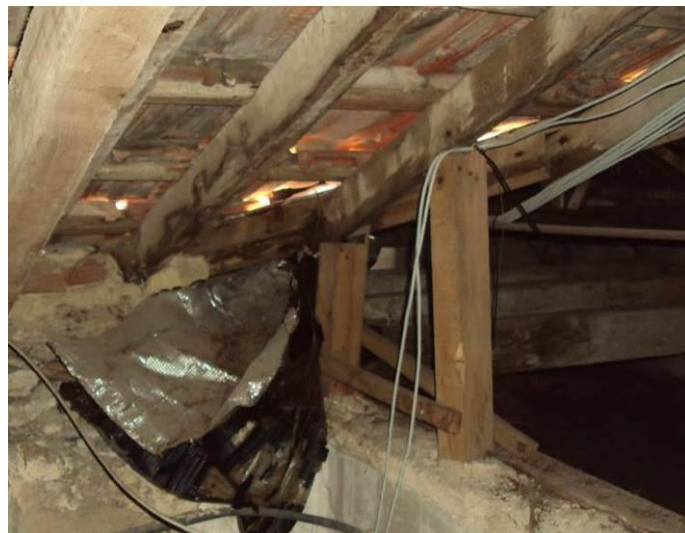
Figura 115: Degradação da madeira proveniente da infiltração pela cobertura (Fonte: Autor, 2016)
