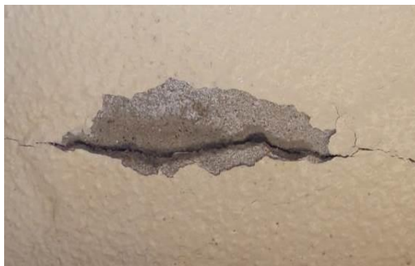
Figura 28: Fissuração e destacamento do reboco (Fonte: Autor, 2016)
