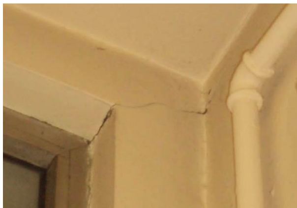
Figura 27: Fendilhação do suporte junto à janela (Fonte: Autor, 2016)
