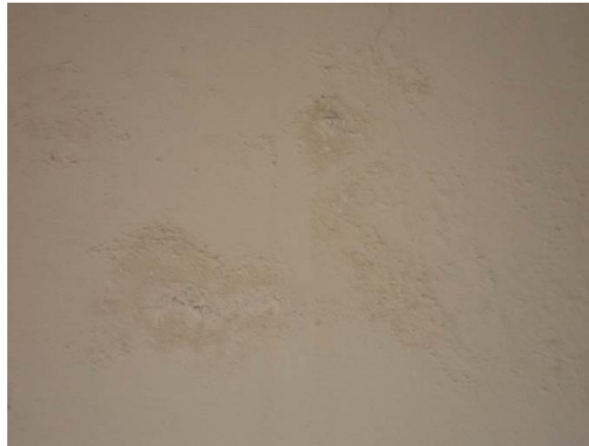
Figura 71: Eflorescências e destacamento do revestimento da parede (Fonte: Autor, 2016)
