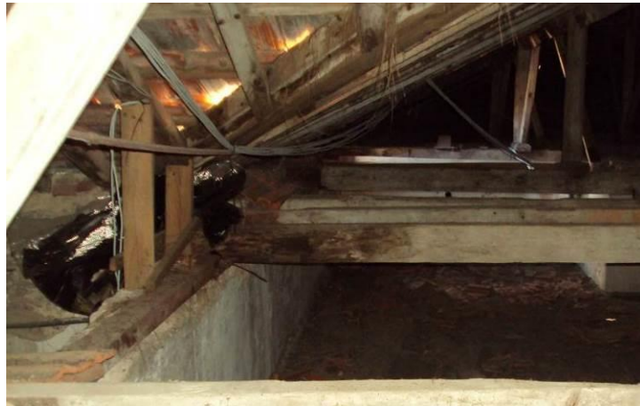
Figura 116: Humedecimento da asna da cobertura (Fonte: Autor, 2016)
