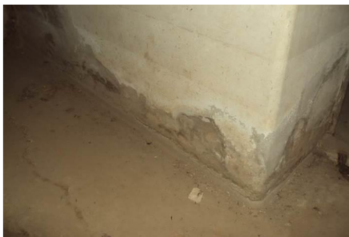
Figura 19: Humidade na parede e rodapé devido à ascensão de água por capilaridade (Fonte: Autor, 2016)
