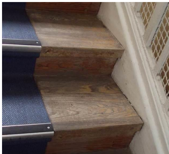
Figura 104: Desligamento do piso de madeira e seu estado de envelhecimento (Fonte: Autor, 2016)
