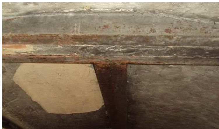
Figura 29: Oxidação da estrutura metálica presente na cave do Pavilhão 24A (Fonte: Autor, 2016)
