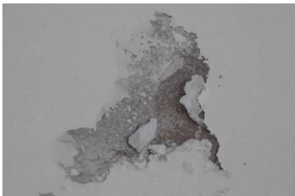
Figura 22: Descolamento do revestimento da parede (Fonte: Autor, 2016)
