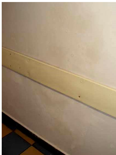
Figura 85: Manchas de humidade e eflorescências no revestimento (Fonte: Autor, 2016)
