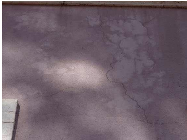
Figura 56: Manchas de humidade proveniente de uma infiltração (Fonte: Autor, 2016)
