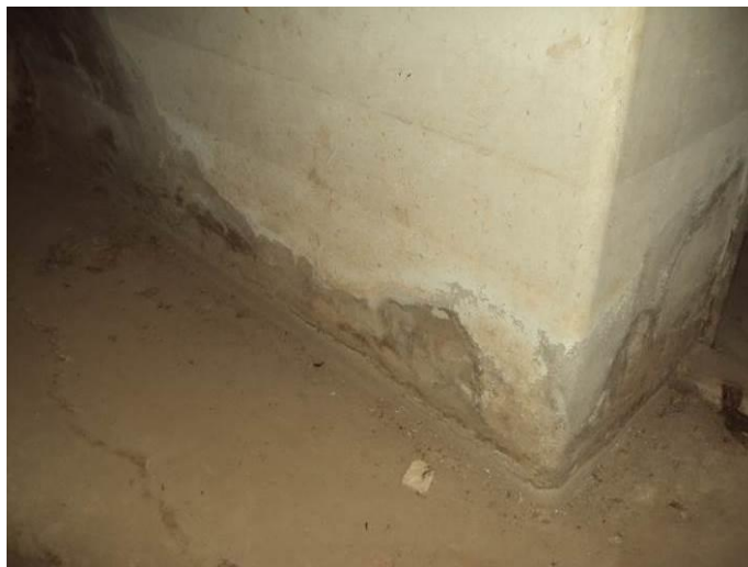
Figura 110: Ascensão de água por capilaridade nas paredes da cave (Fonte: Autor, 2016)
