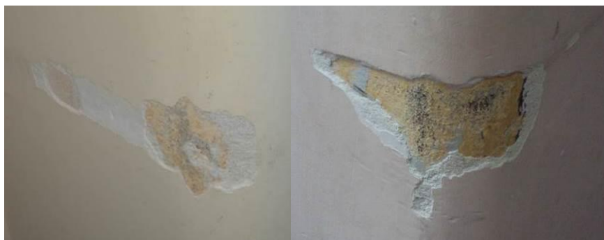
Figura 62: Destacamento acentuado do reboco na parede (Fonte: Autor, 2016)
