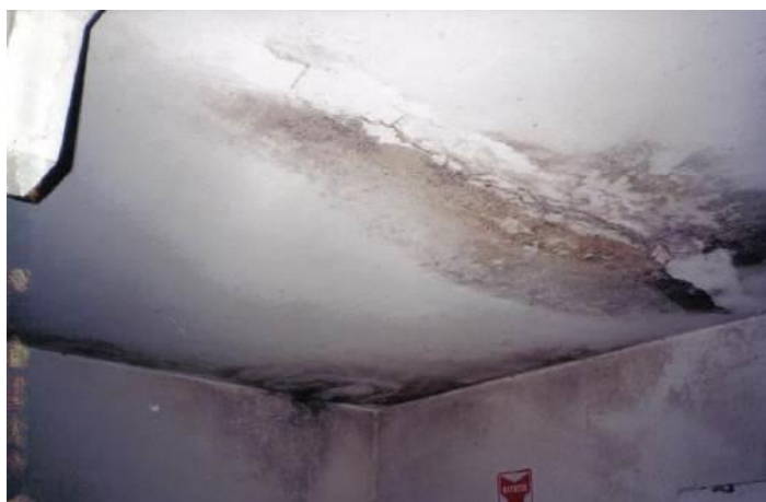
Figura 17: Humidade de precipitação no teto proveniente da cobertura [16]
