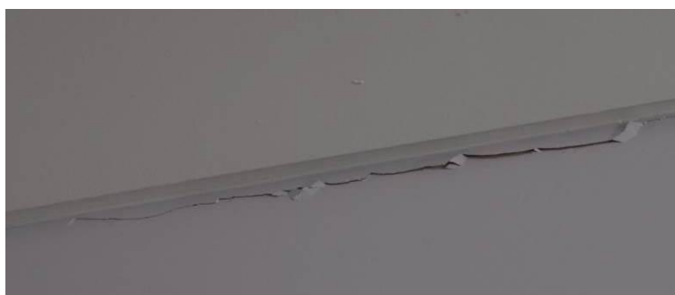
Figura 74: Fissura horizontal ao longo de toda a parte superior da parede (Fonte: Autor, 2016)
