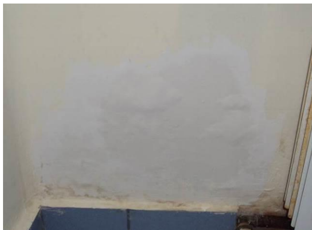
Figura 69: Empolamento do revestimento num quarto (Fonte: Autor, 2016)
