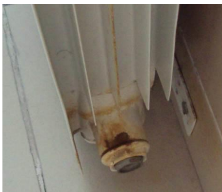
Figura 93: Oxidação da tubagem do radiador na divisão n.º 30 do piso 0 (Fonte: Autor, 2016)
