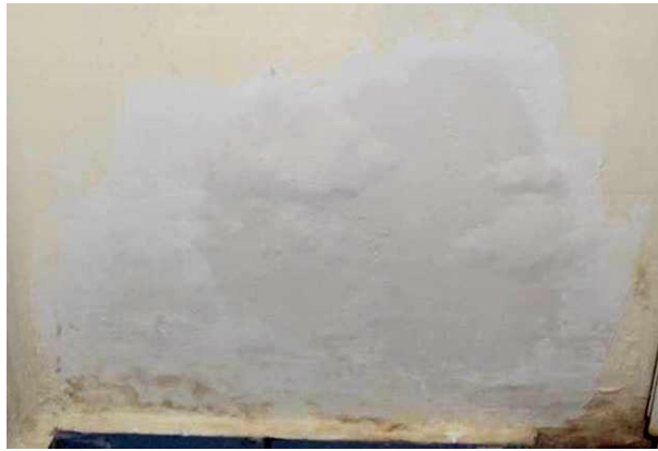
Figura 23: Empolamento do revestimento da parede (Fonte: Autor, 2016)
