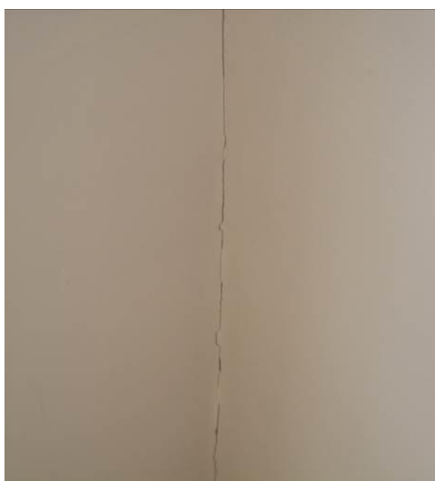
Figura 80: Fissura localizada na parede do corredor (Fonte: Autor, 2016)
