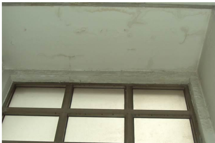
Figura 91: Manchas de humidade e empolamento na instalação sanitária n.º 37 (Fonte: Autor, 2016)
