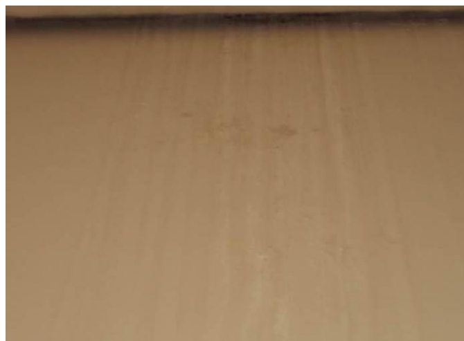
Figura 72: Eflorescências e criptoflorescências na parede, com destacamento (Fonte: Autor, 2016)
