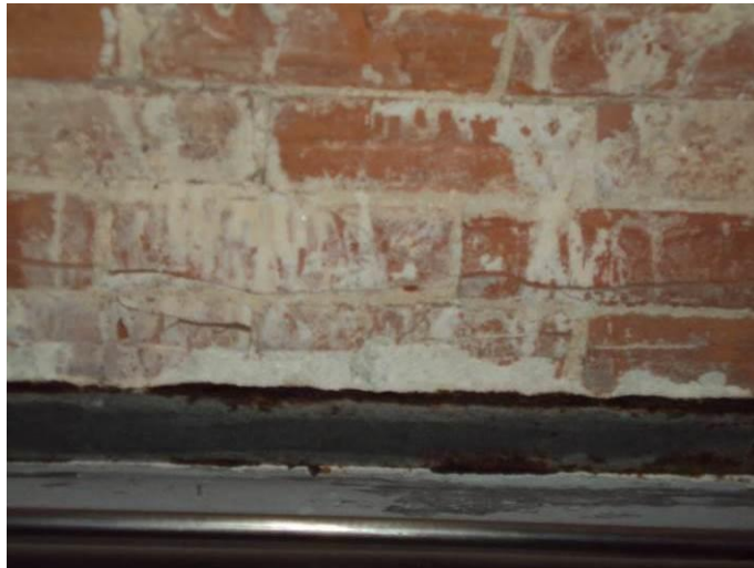
Figura 109: Fratura longitudinal do tijolo cerâmico (Fonte: Autor, 2016)
