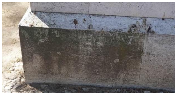
Figura 46: Manchas negras e sujidade sobre o lioz (Fonte: Autor, 2016)
