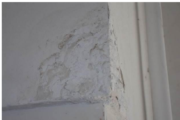
Figura 18: Humidade de condensação na parede da instalação sanitária (Fonte: Autor, 2016)
