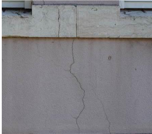
Figura 51: Fendilhação vertical localizada no tardo do edifício (Fonte: Autor, 2016)
