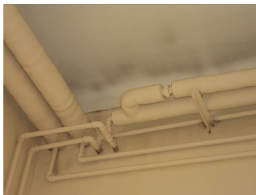
Figura 99: Manchas resultantes de fugas na canalização na divisão n.º 39 do piso 1 (Fonte: Autor, 2016)
