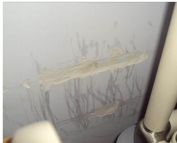
Figura 63: Destacamento do reboco devido a colisões (Fonte: Autor, 2016)
