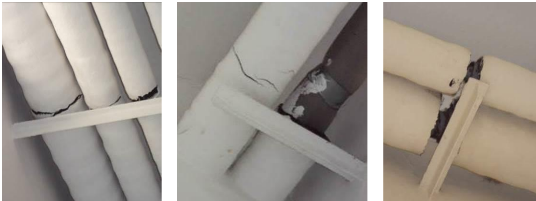
Figura 60: Fissuração do revestimento da canalização em zonas de apoio (Fonte: Autor, 2016)
