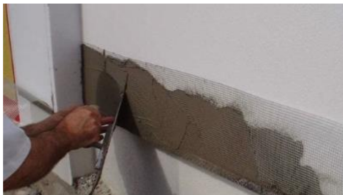
Figura 118: Aplicação de reboco armado com o auxílio de uma palustra (Fonte: http://www.pintaracasa.com )
