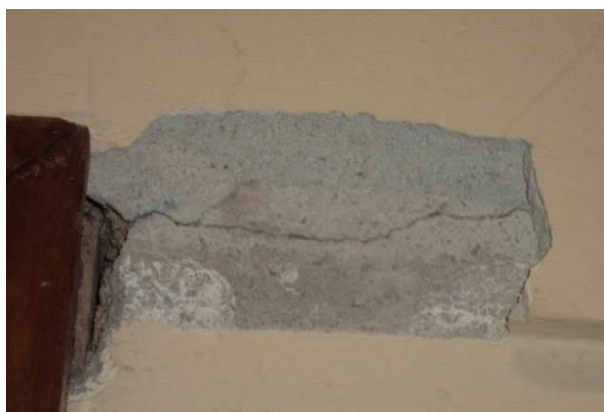
Figura 66: Destacamento do reboco junto à batente da porta (Fonte: Autor, 2016)
