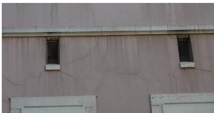
Figura 48: Escorrência na fachada sob o friso de lioz (Fonte: Autor, 2016)
