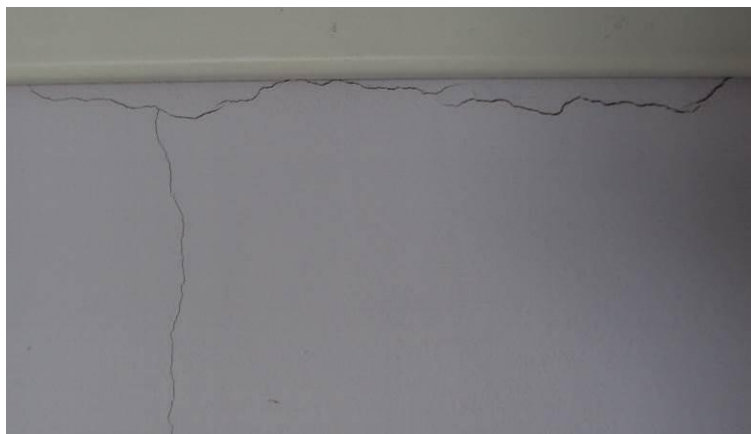
Figura 75: Fissura ao longo de toda a parede (Fonte: Autor, 2016)
