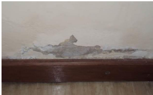
Figura 24: Empolamento e destacamento do revestimento junto ao rodapé (Fonte: Autor, 2016)
