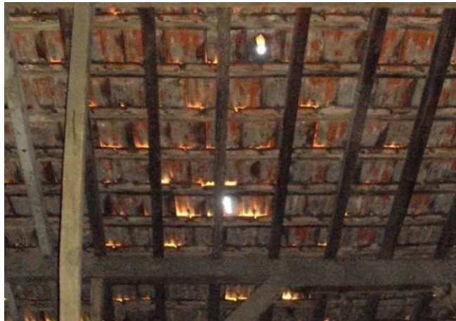
Figura 114: Degradação de telhas da cobertura (Fonte: Autor, 2016)
