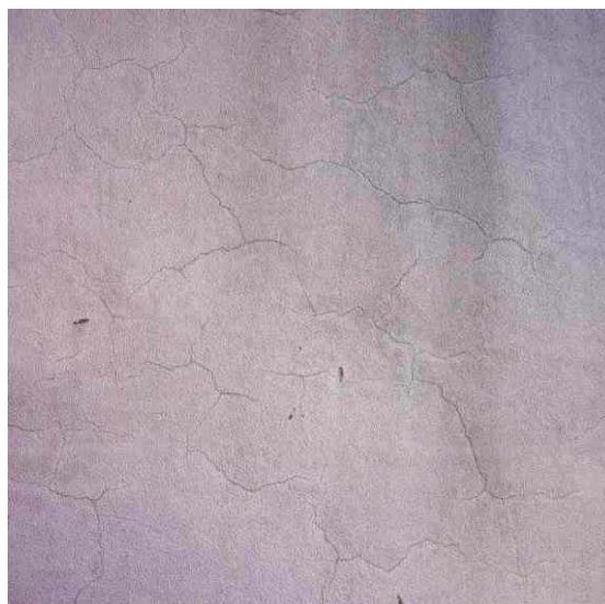
Figura 26: Retração do reboco na fachada do Pavilhão 24A (Fonte: Autor, 2016)
