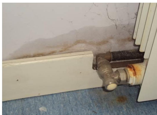
Figura 87: Mancha de humidade junto ao rodapé do gabinete n.º 39 (Fonte: Autor, 2016)
