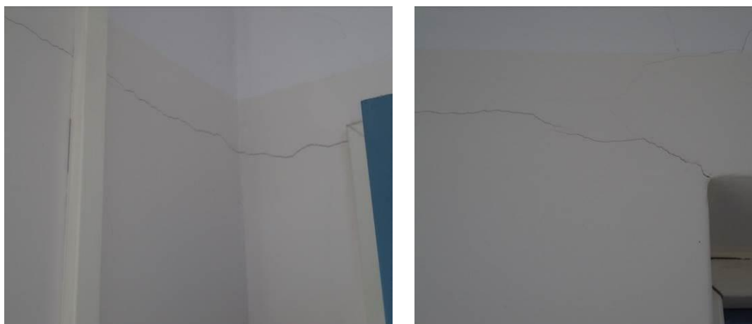
Figura 76: Fissuração do revestimento da parede do corredor (Fonte: Autor, 2016)
