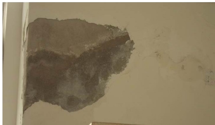
Figura 21: Eflorescências na parede e destacamento do revestimento (Fonte: Autor, 2016)
