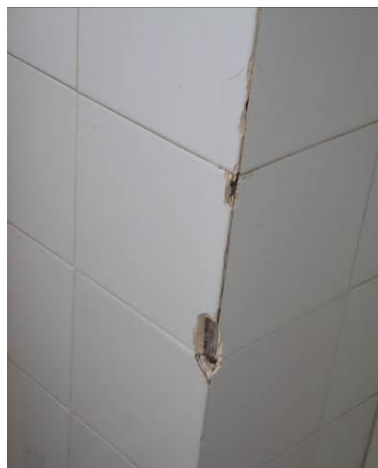
Figura 101: Fratura dos azulejos na instalação sanitária n.º 11 do piso 1 (Fonte: Autor, 2016)
