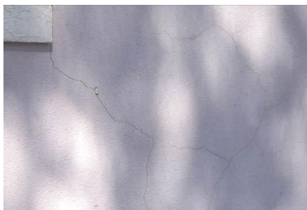
Figura 49: Fendilhação mapeada na fachada do Pavilhão 24A (Fonte: Autor, 2016)
