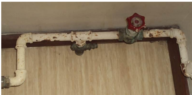
Figura 94: Oxidação da tubagem do radiador no corredor A do piso 1 (Fonte: Autor, 2016)
