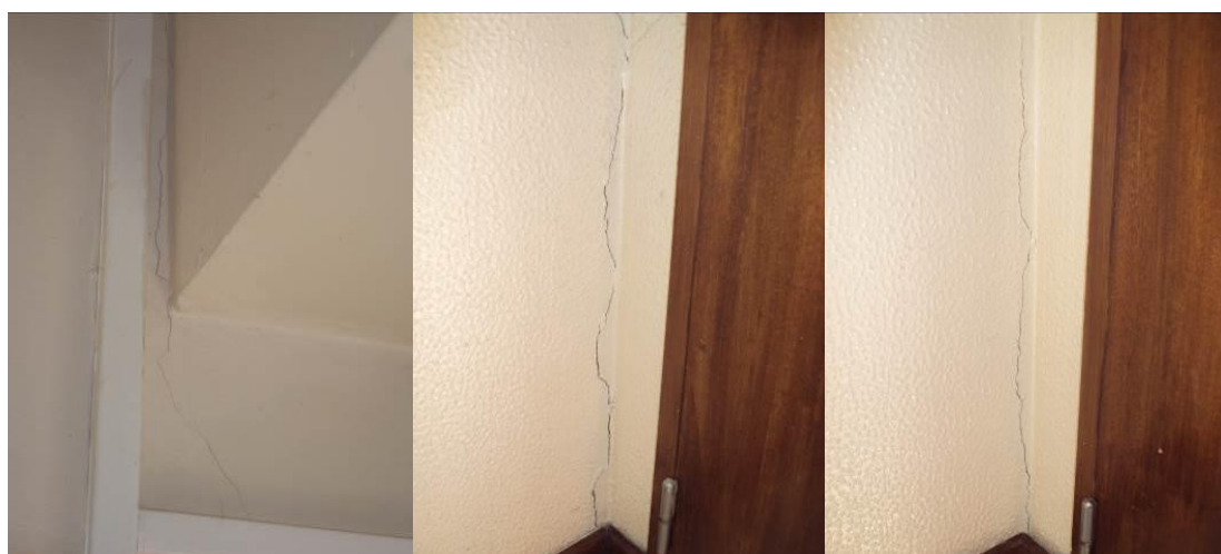
Figura 78: Fissura vertical ao longo de toda a parede da divisão (Fonte: Autor, 2016)
