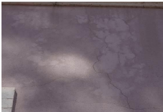
Figura 53: Fissuração do revestimento proveniente de uma infiltração (Fonte: Autor, 2016)
