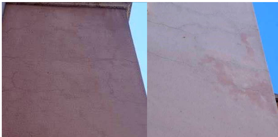
Figura 55: Manchas de humidade na fachada (Fonte: Autor, 2016)
