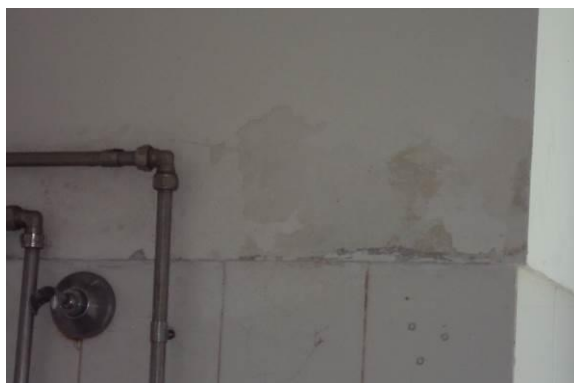
Figura 89: Manchas de humidade na instalação sanitária n.º 4 (Fonte: Autor, 2016)
