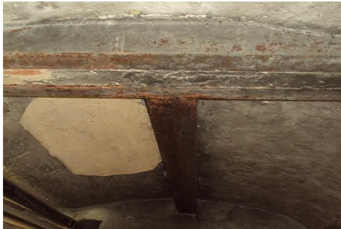
Figura 111: Perfis metálicos com visíveis sinais de oxidação (Fonte: Autor, 2016)
