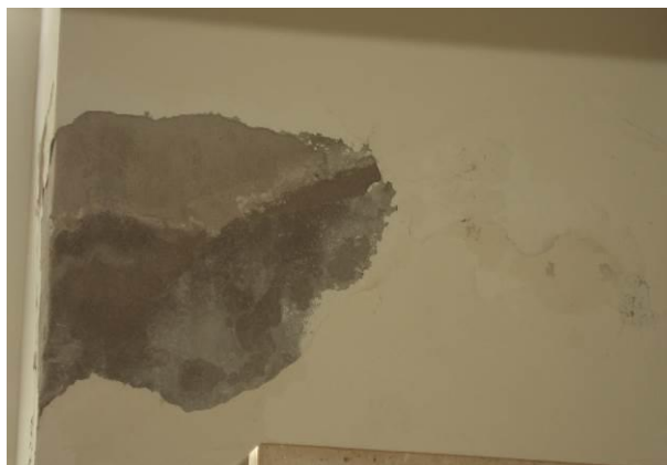
Figura 90: Humidade e destacamento do revestimento na instalação sanitária n.º 4 (Fonte: Autor, 2016)
