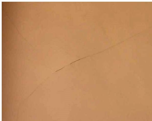
Figura 106: Fissuração do revestimento ao longo de toda a parede (Fonte: Autor, 2016)
