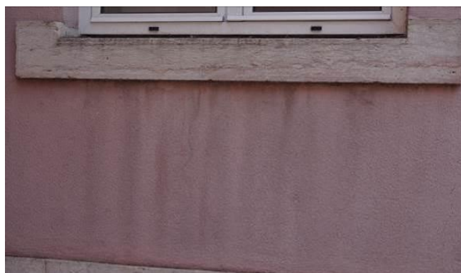
Figura 47: Escorrência na fachada sob o peitoril (Fonte: Autor, 2016)
