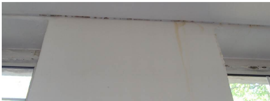
Figura 83: Manchas de humidade, bolor e descolamento do revestimento (Fonte: Autor, 2016)
