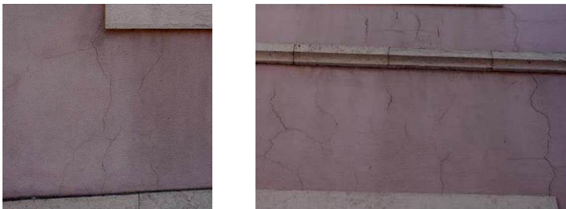
Figura 52: Fissuração acentuada do revestimento da parede exterior (Fonte: Autor, 2016)
