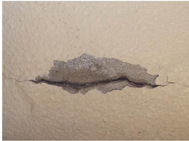
Figura 67: Destacamento do reboco no corredor resultante de fissuração (Fonte: Autor, 2016)
