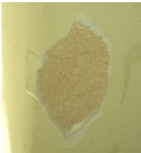
Figura 65: Destacamento do reboco na parede (Fonte: Autor, 2016)
