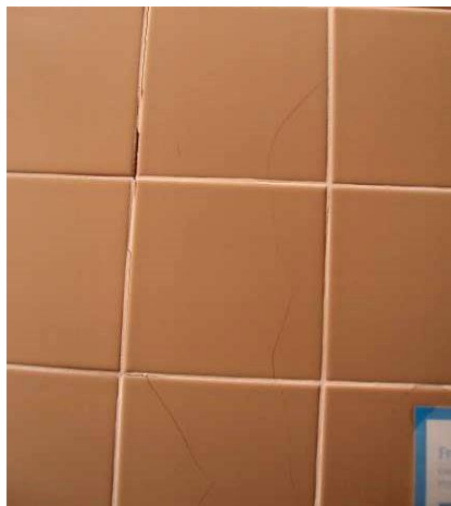
Figura 100: Azulejos partidos na instalação sanitária n.º 30 do piso 0 (Fonte: Autor, 2016)
