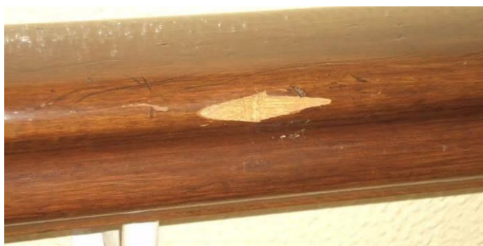
Figura 105: Abrasão do corrimão de madeira em zonas pontuais (Fonte: Autor, 2016)
