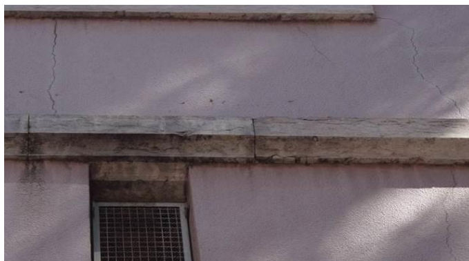
Figura 20: Escorrência na parede exterior sob o lioz situado entre os dois pisos (Fonte: Autor, 2016)
