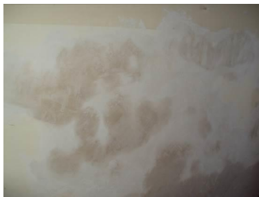
Figura 97: Manchas no revestimento da parede da divisão n.º 13 do piso 0 (Fonte: Autor, 2016)
