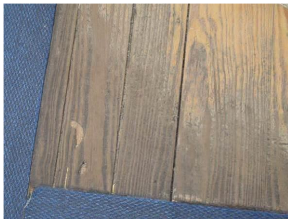
Figura 103: Envelhecimento e abrasão do soalho de madeira (Fonte: Autor, 2016)
