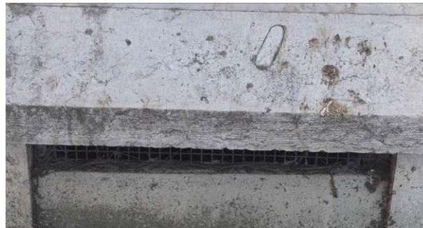
Figura 45: Manchas negras e sujidade sobre o lioz (Fonte: Autor, 2016)
