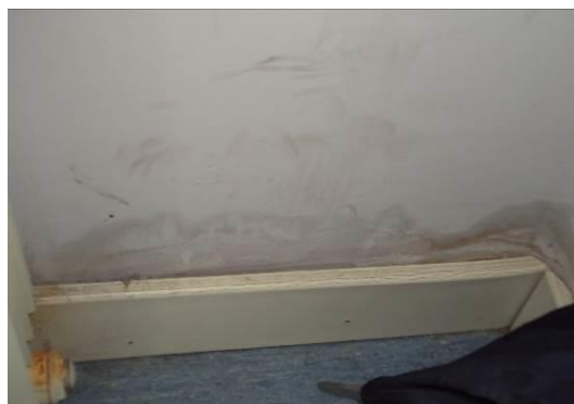
Figura 86: Mancha de humidade junto ao rodapé do gabinete n.º 27 (Fonte: Autor, 2016)
