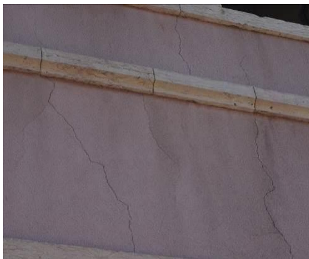
Figura 50: Fendilhação vertical sob a faixa de lioz (Fonte: Autor, 2016)
