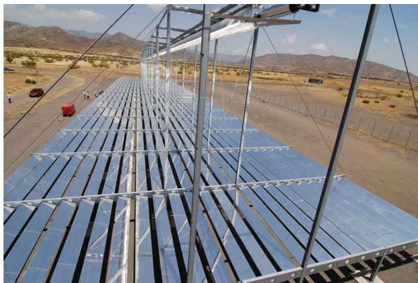
Figura 14 – Concentradores lineares com reflector Fresnel (Plataforma Solar de Almería)
