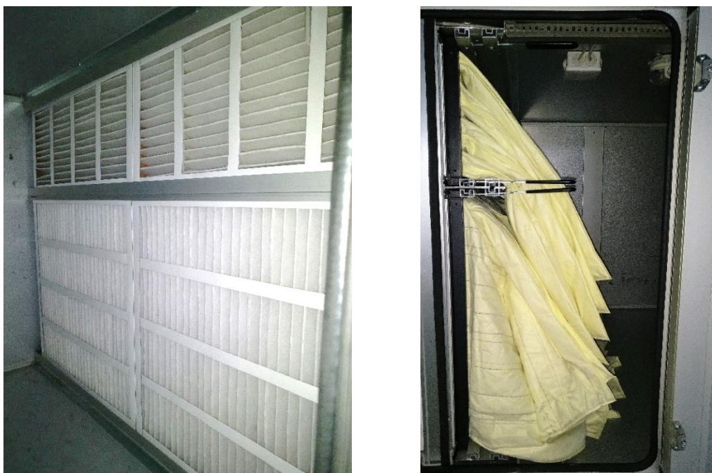
Figura 4.4 – Pré-filtros G4 (esquerda); Filtro F7 (direita)
