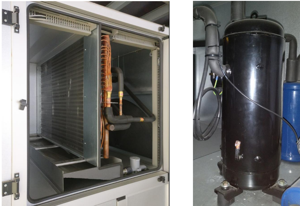
Figura 4.7 – Bateria de aquecimento/arrefecimento (esquerda); Compressor (direita)
