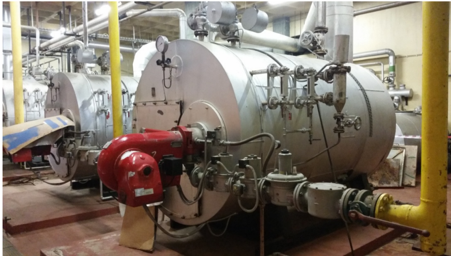
Figura 54 – Caldeiras de vapor na estação de produção de calor.
