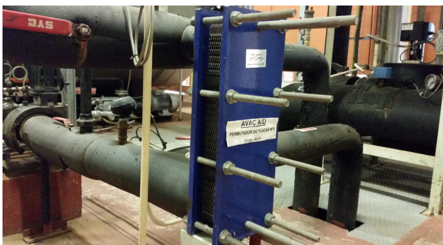
Figura 55 – Permutador de placas nº 3, do tipo água-água.
