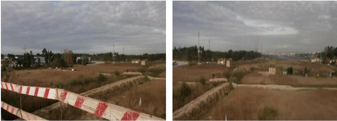
Imagem 13 - Estado construtivo do Pontão no início do estágio. Visualização do estrado em rachão e tout-venant
