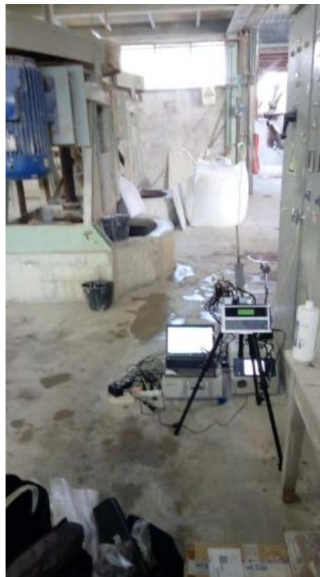
Figura 29 - Zona de mistura / preparação de pastas
