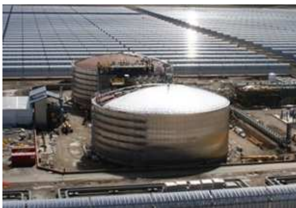
Figura 2.11 – Tanque de armazenamento de energia térmica [50].
