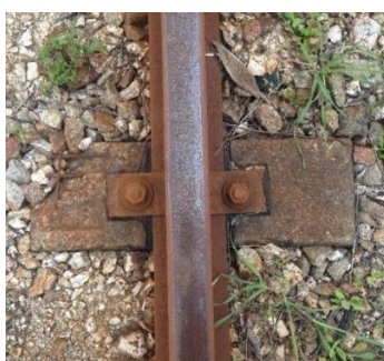
Figura 4.12 - Degradação em travessa bi-bloco
