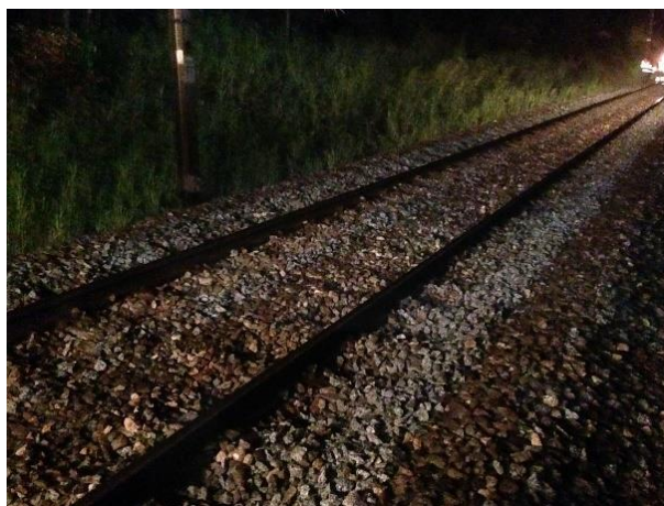
Figura 5.4 - Estado da plataforma após passagem do ataque pesado
