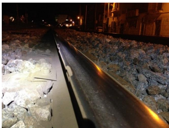
Figura 4.8 - Deformação da face interna do carril devido a esmagamento
