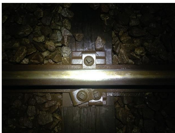
Figura 4.15 - Aperto das fixações inexistente
