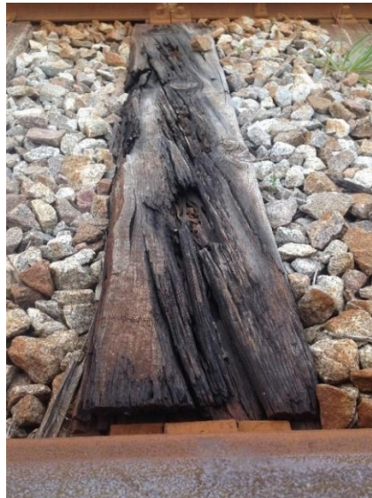
Figura 4.11 - Degradação da travessa de madeira
