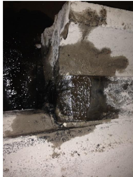
Figura 6.24 - Zona de fissuração do carril, vista de cima
