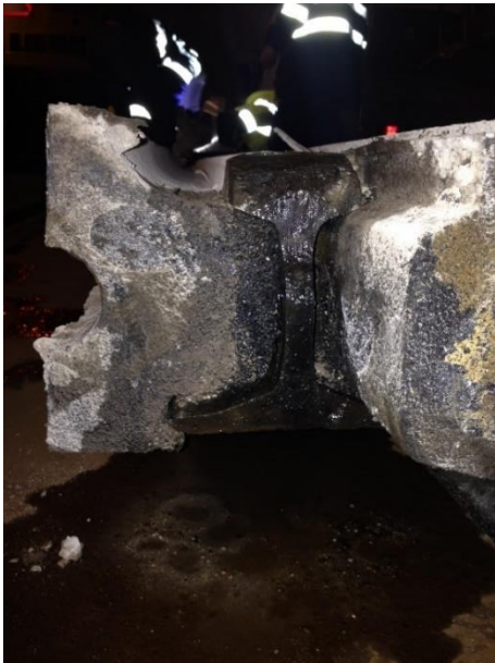
Figura 6.23 - Zona de fissuração do carril
