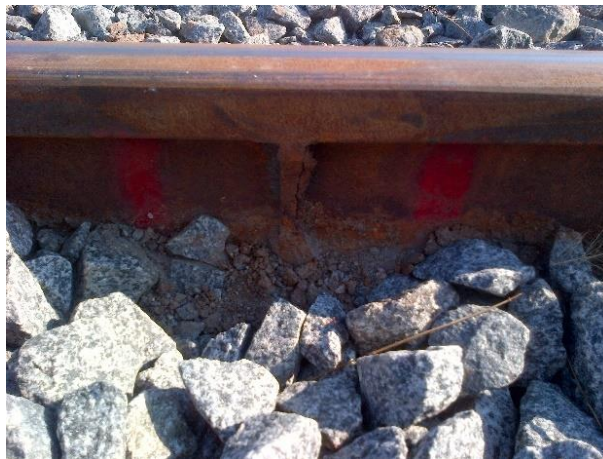
Figura 4.9 - Defeito visível na execução da soldadura (Fonte: Eng a Maria Peneda)
