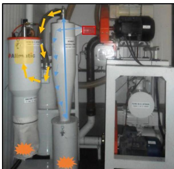
Figura 3.54- Sistema de remoção de partículas em suspensão do sistema de vácuo
