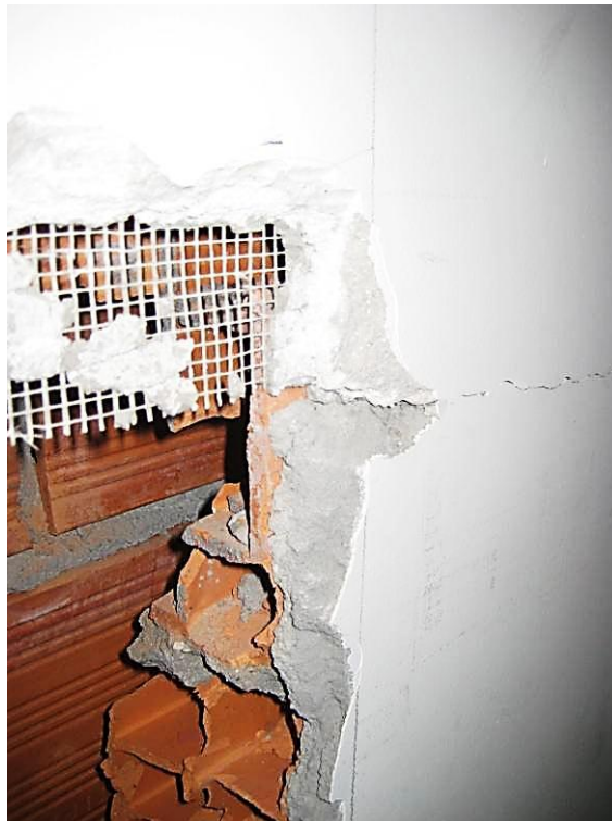
Figura II.9.2 – Edifício Sede de Escritórios em Coimbra - Sondagem S4.3 (Reboco executado em dois momentos diferentes, identificado pela coloração diferente)
