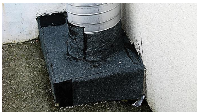
Figura V.2.3 – Centro de Atendimento Permanente em Seia (patologias do edifício) - Má execução de maciço
