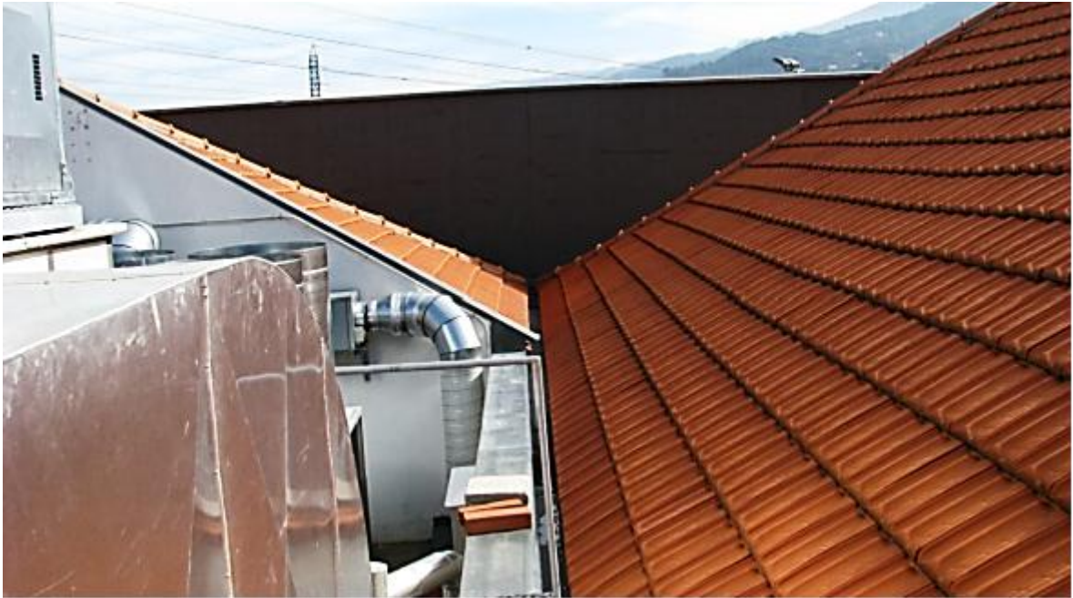
Figura V.3 – Centro de Atendimento Permanente em Seia (patologias do edifício) - Acesso a cobertura inclinada
