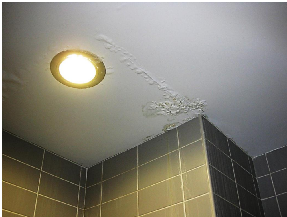
Figura V.1.1 – Centro de Atendimento Permanente em Seia (patologias do edifício) - Humidades em tecto interior
