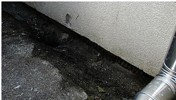
Figura V2.1 – Centro de Atendimento Permanente em Seia (patologias do edifício) - Má execução ITE
