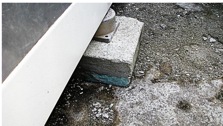
Figura V.2.2 – Centro de Atendimento Permanente em Seia (patologias do edifício) - Betonilha “esfarelada”
