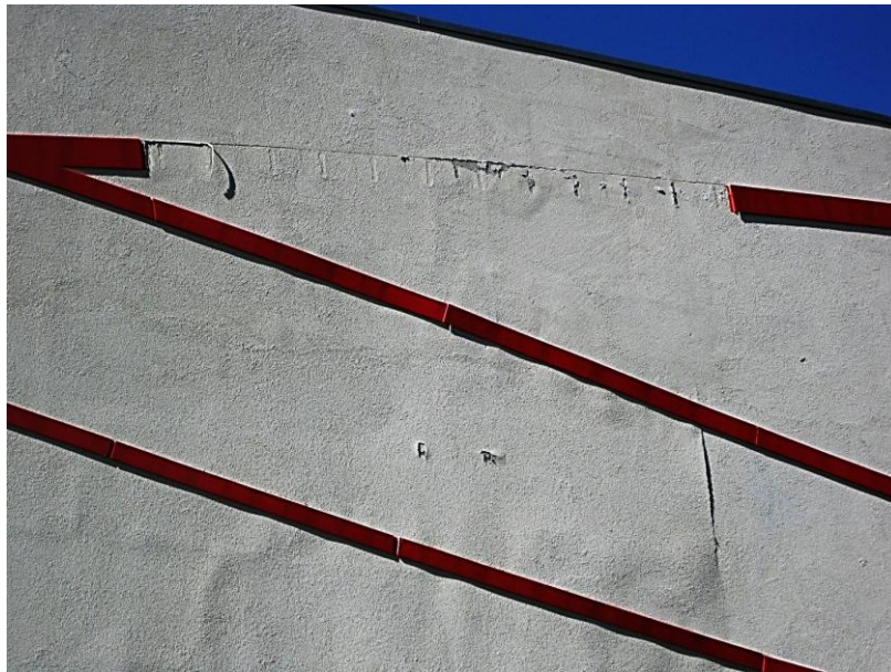
Figura V.4.1 – Centro de Atendimento Permanente em Seia (patologias do edifício) - Descolamento ITE
