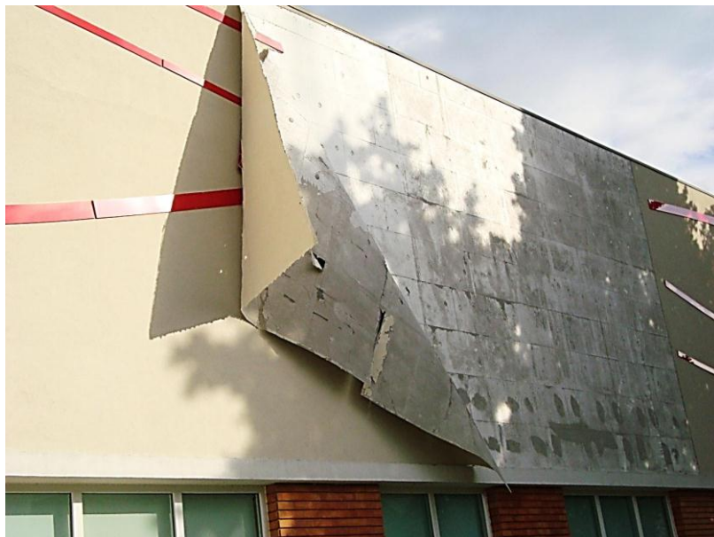
Figura V.4.2 – Centro de Atendimento Permanente em Seia (patologias do edifício) - Descolamento ITE
