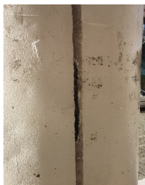
Figura 3.20 Degradação da junta de dilatação.
