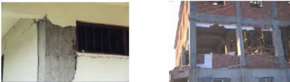
Figura 3.8 Patologias nos pilares e nos painéis devido à existência de grandes aberturas.
