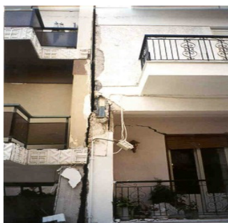
Figura 3.5 Efeitos da colisão de edifícios adjacentes após o sismo de 1999, Atenas ( http://www.nexus.globalquakemodel.org/ ).
