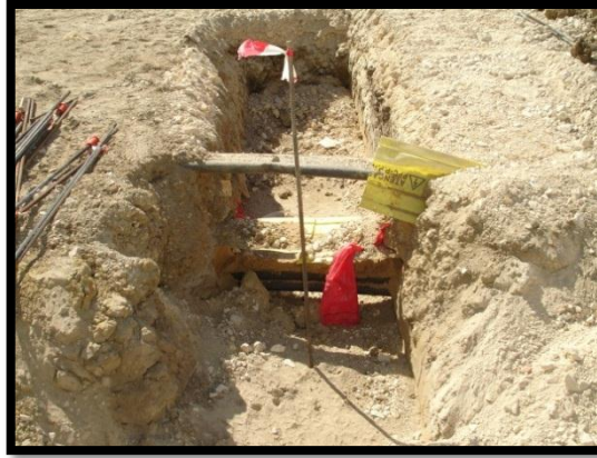
Figura 2.26 – Cabos de média tensão
