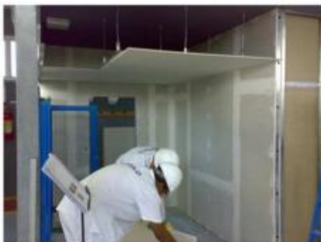
Figura 11 – Desencontro entre placas (Construlink, 2013)
