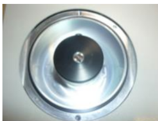
Figura 28 - Grelha de cobre no NAS.
