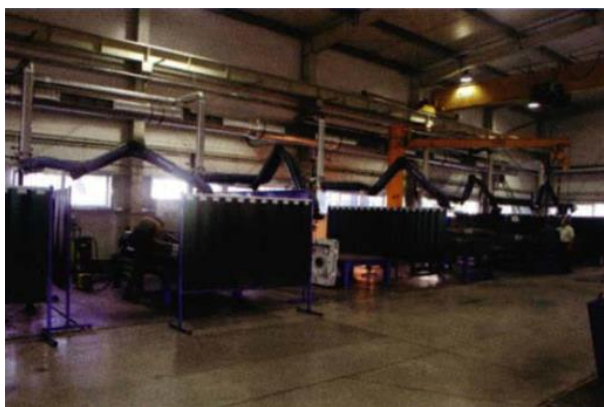
Figura 74 - Oficina de soldadura equipada com um sistema de extração local [54].
