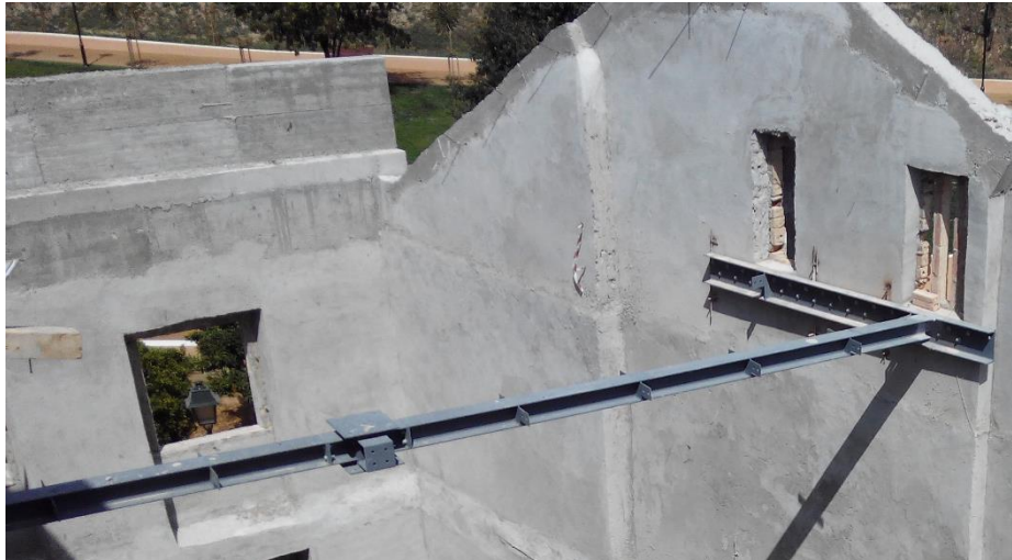
Figura 25 - HEA 180 ligado a UNP 260 periférico e com cabeçal para ligação a HEA 160 e pilar SHS 180
