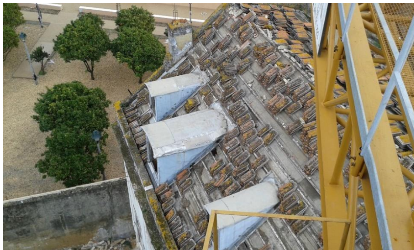
Figura 11 - Início da remoção da cobertura do edifício da Rua dos Lagares nº 72 e 74
