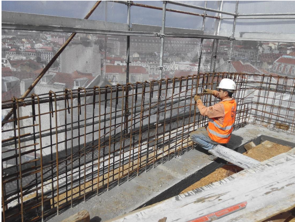
Figura 15 - Aplicação da armadura no guarda-fogo do edifício da Rua dos Lagares nº 72 e 74
