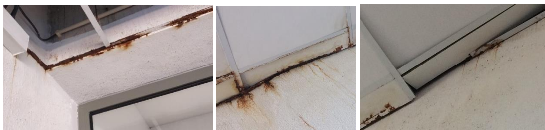
Figura 61- Exemplos de corrosão proveniente de uma má desumidificação na Piscina Municipal do Alvito.
