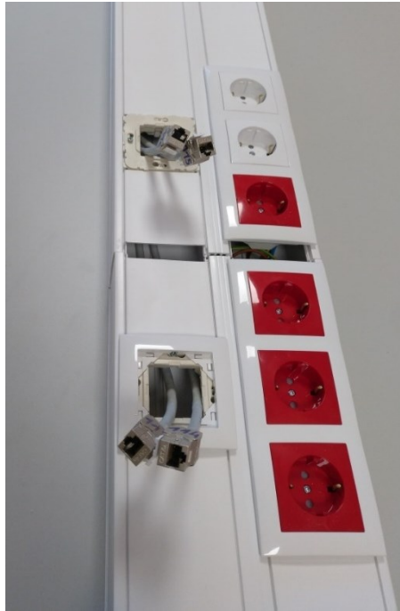
Figura 4.33 Condições de teste rede (1ª fase)
