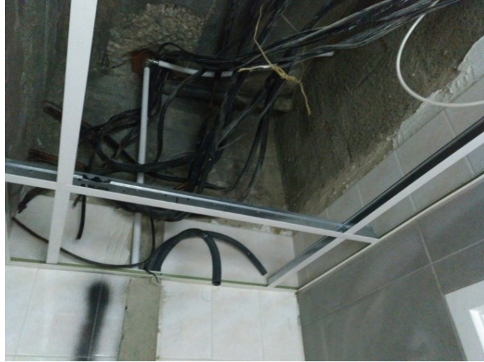
Figura 4.19 - Pormenor da passagem de tubagem pelos tetos (opção executada).
