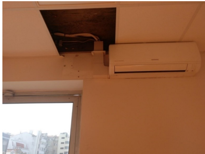
Figura 4.30 - Aplicação de teto falso acústico, permitindo a fácil manutenção de equipamentos.
