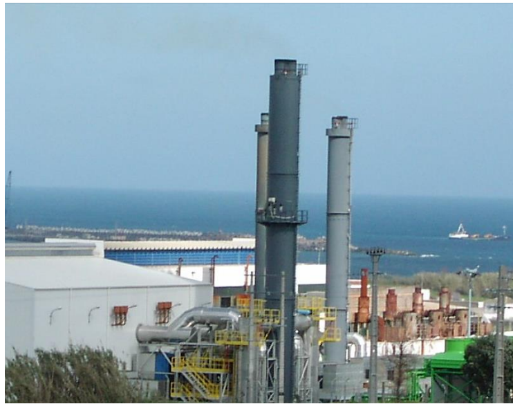
Figura 3.11 – Central Termoelétrica do Belo Jardim [30]
