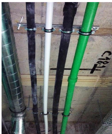
Figura 73 - Tubagem suspensa à laje por meio de abraçadeiras (Fonte: Autor)
