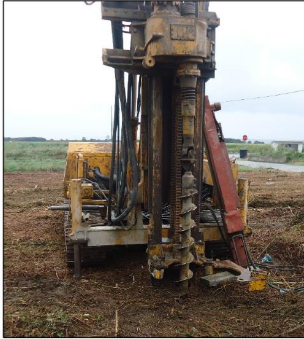
Figura 4 - Perfuração a trado oco (Fonte: Estudo geológico - Perfil, Fundações e Hidrogeologia, Lda)
