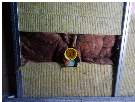
Figura 46 - Instalações elétricas envolvidas em lã de rocha (Fonte: Autor)
