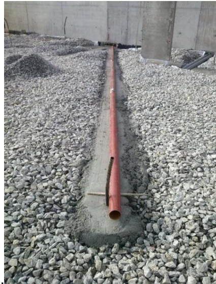
Figura 65 - Tubagem interior Metallit-SMU (Fonte: Autor)
