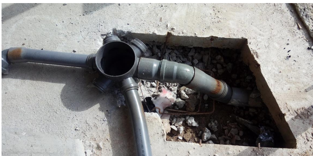
Figura 67 - Caixa de pavimento com as ligações efetuadas (Fonte: Autor)
