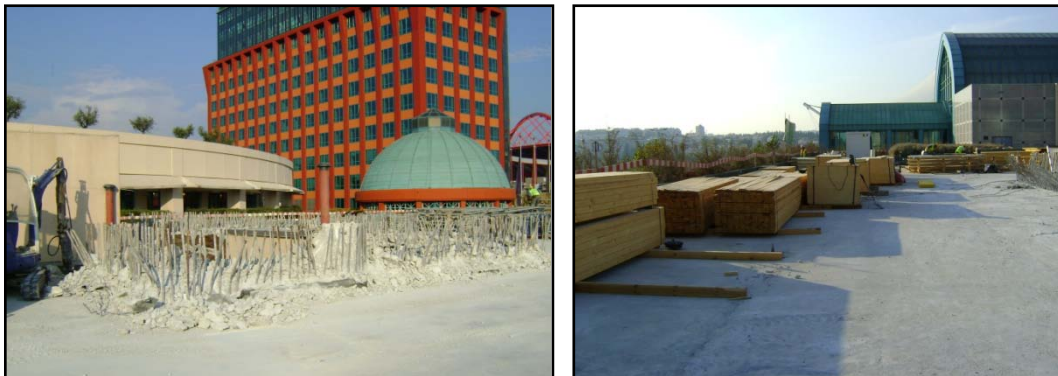
Imagens 76 e 77 – Armadura de espera exposta e material destinado à estrutura da cofragem deslizante ( fonte: Eng.º Hugo Pereira, Mota-Engil )
