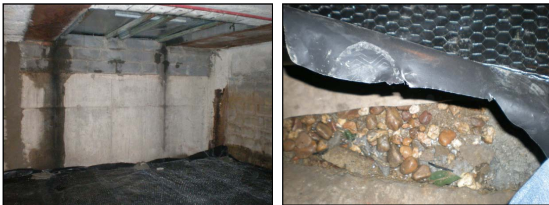
Imagens 51 e 52 – Infiltrações patentes e disposição de camadas
