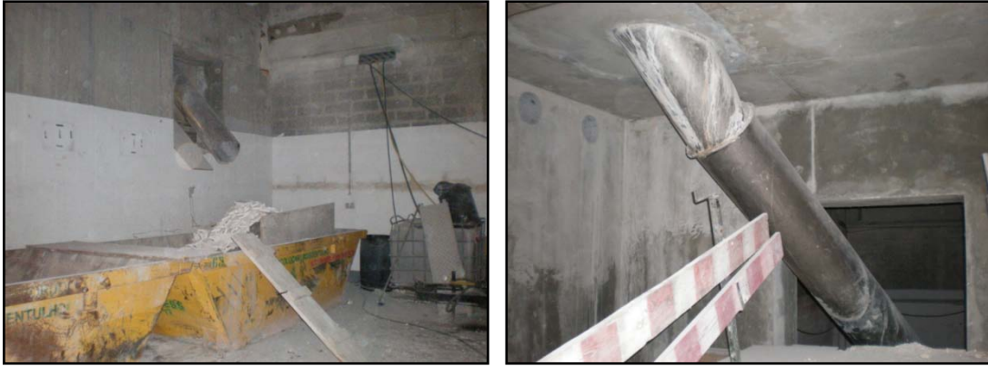
Imagens 5 e 6 – Conduto de ar
