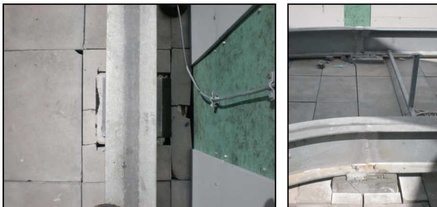
Imagens 57 e 58 – Maciços danificados
