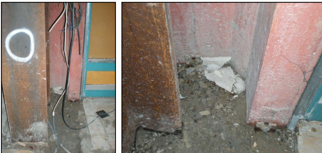
Imagens 70 e 71 – Pilar do alinhamento 13 e espaço diminuto em causa
