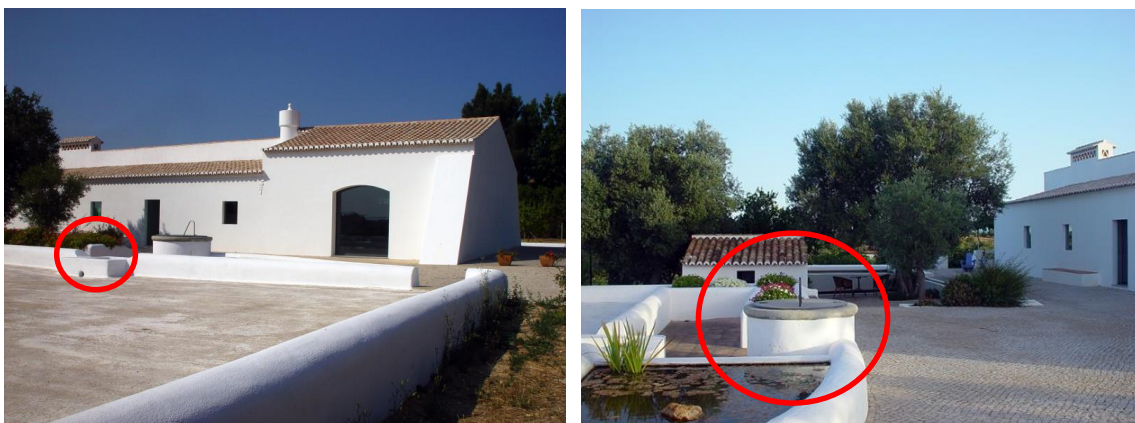
Figura 9 - Eirado onde é visível orifício que comunica com cisterna e boca de acesso
