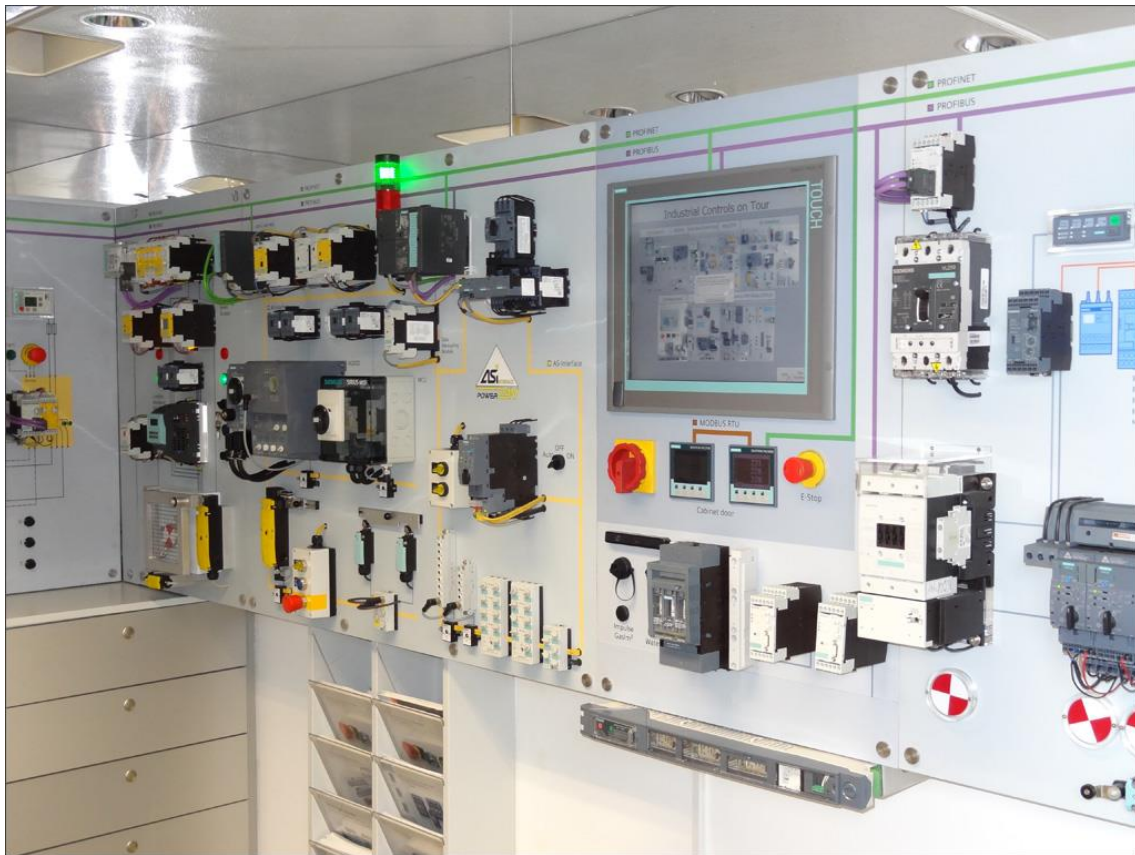
Figura 1.1 – Painel usado no Controlo de um Processo Industrial (El Kontrol LTD, 2014)
