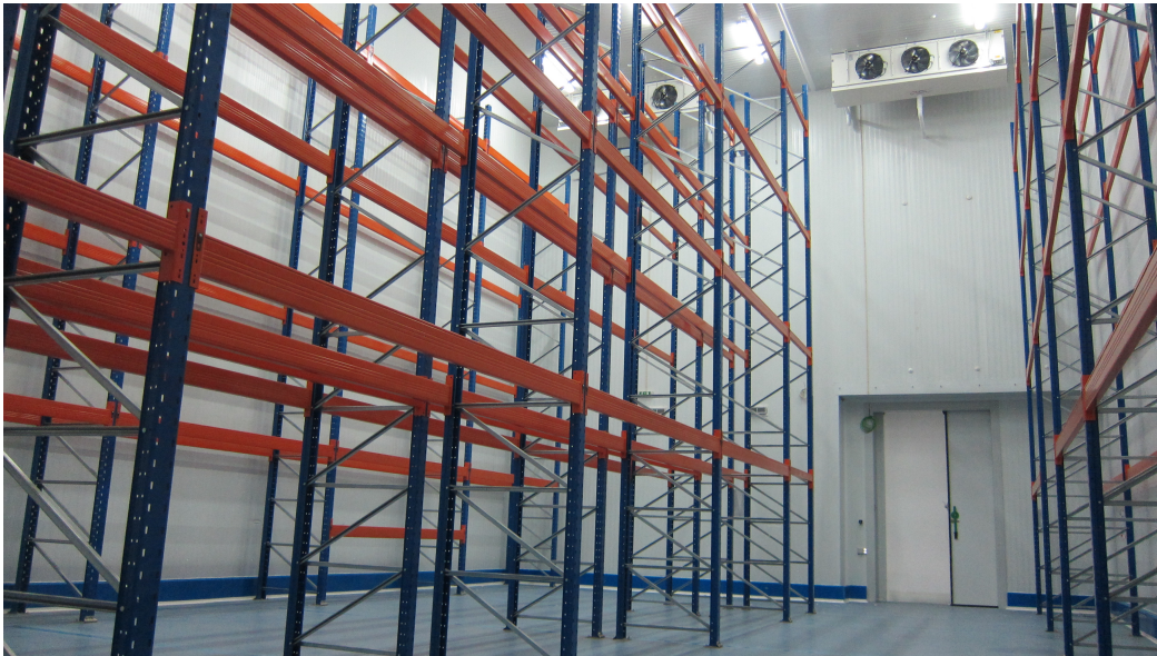
Figura 5 - Pormenor da estrutura de armazenagem fixa da Câmara de Congelados
