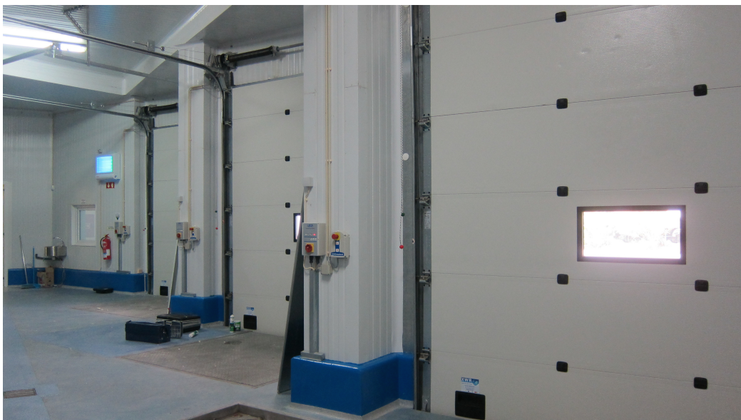
Figura 7 -Pormenor das portas exteriores de acesso aos cais para cargas e descargas.
