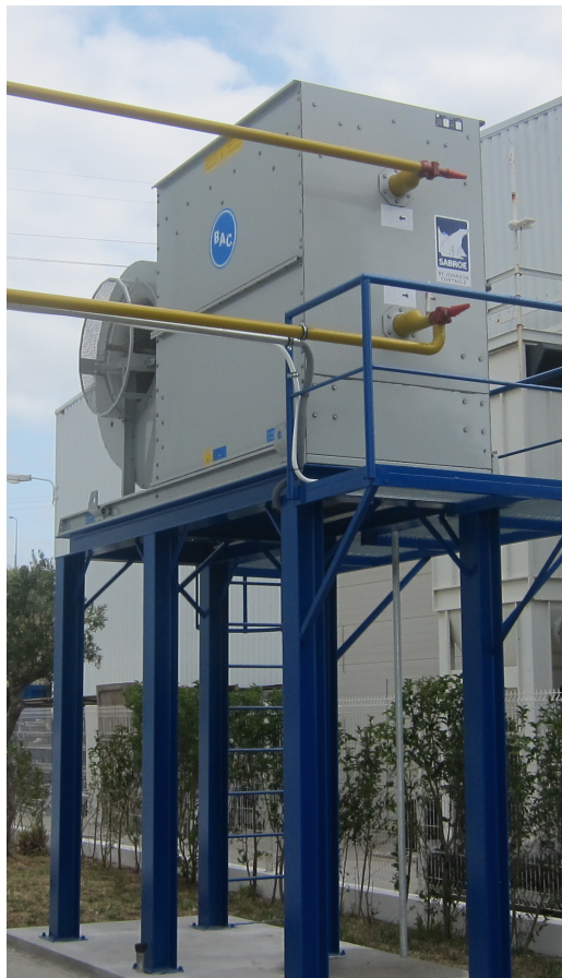
Figura 24 - Pormenor do Condensador e da sua estrutura de suporte.
