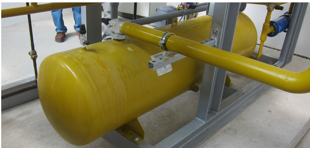
Figura 25 - Pormenor do Depósito de Líquido na Casa de Máquinas
