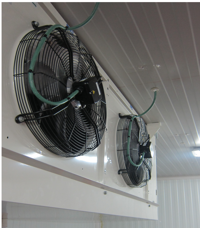
Figura 14 - Pormenor do Evaporador da Câmara de Refrigerados
