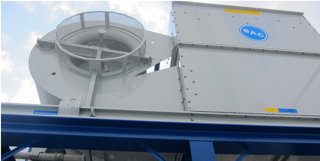
Figura 23 - Pormenor do Condensador
