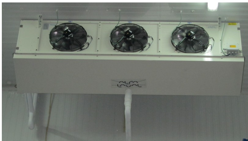
Figura 13 - Pormenor do Evaporador instalado na Câmara de Congelados
