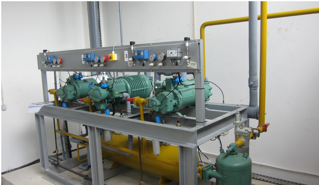
Figura 20 - Unidade multicompressora instalada na Casa de Máquinas
