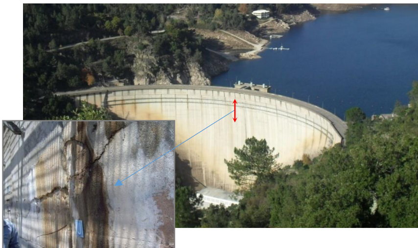
Figura 1.1 - Fendilhação em estruturas de betão em zonas tracionadas (barragem do Cabril).
