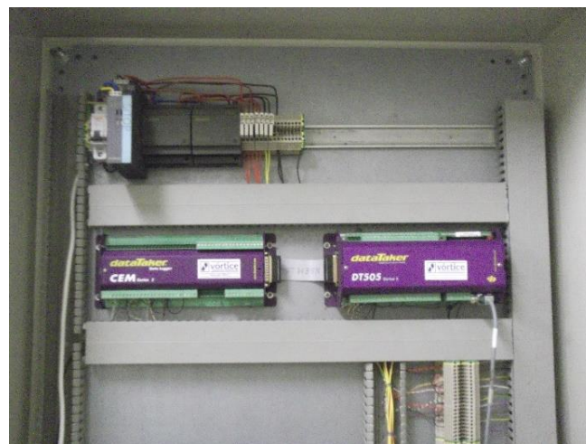
Figura 4.27 – Sistema eletrónico para aquisição dos dados dos transdutores de carga e dos transdutores de deslocamento.
