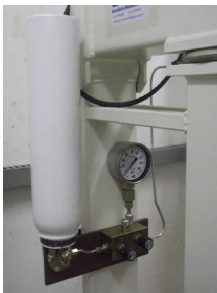
Figura 4.24 – Acumulador (com interface óleo-gás) do sistema óleo-hidráulico, manómetro analógico e bloco de válvulas do circuito óleo-hidráulico.
