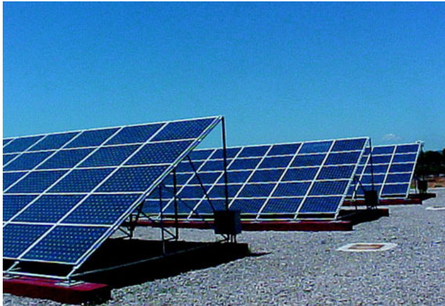
Fig. 14 - Painéis solares térmicos [19].
