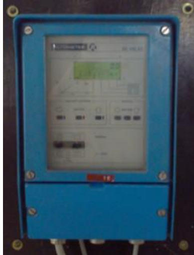
Figura 4.10 - Caudalímetro existente na instalação experimental.
