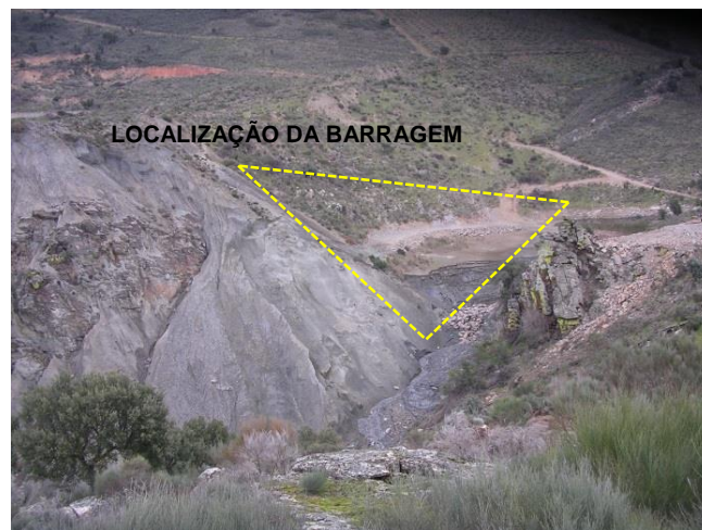
Figura 2.6 - Barragem da mina da Fonte Santa após a rotura por galgamento (Mogadouro - Portugal).
