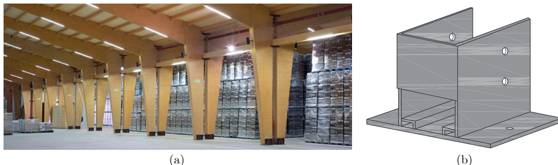
Figura 3.15 – Ligação Pilar-Base: a) Herdade de Esporão [Adaptado (Jular, 2021)]; b) ferragem de ligação base com pilar.
