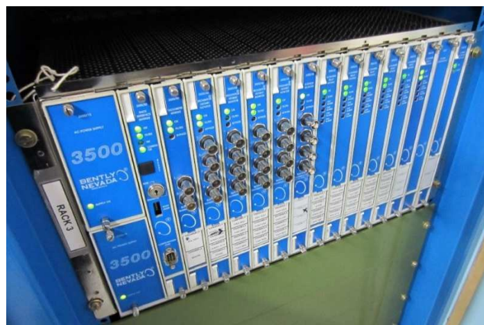
Figura 4.46 - Bently Nevada 3500 instalado no Complexo Petroquímico
