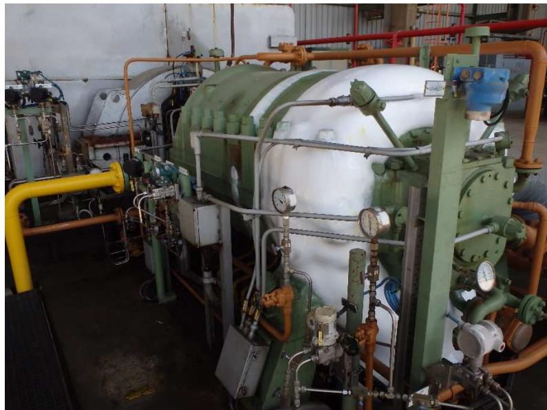
Figura 4.52 - X4201 turbocompressor gás propileno
