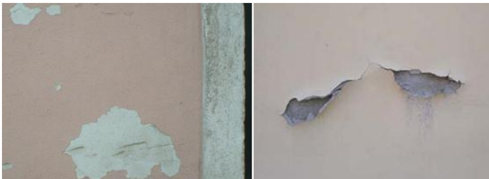
Figura 3.5 - Abertura da zona dilatada devido a criptoflorescências [13]
