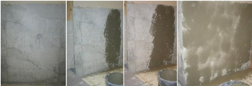
Figura 5.41 - Salpicos de argamassa projectados contra o suporte
