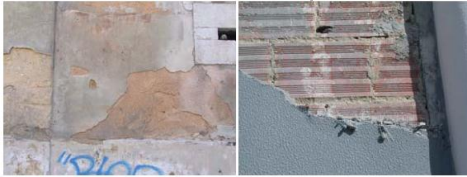
Figura 3.7 - Destacamento de rebocos [13]
