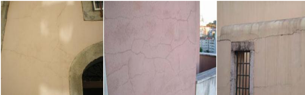
Figura 3.9 - Exemplos de fissuração e fendilhação [13]
