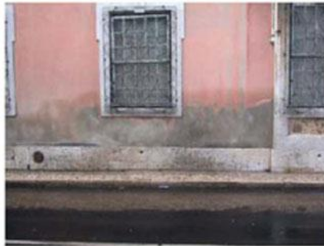
Figura 3.3 - Humidade existente através das manchas evidentes, cerca de 1 metro de altura [13]
