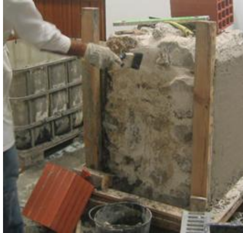
Figura 5.35 - Humedecimento da alvenaria ordinária
