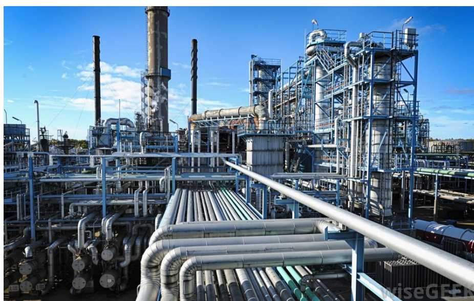
Figura 5.1 – Piping de processo (Fonte: http://www.wisegeek.org )
