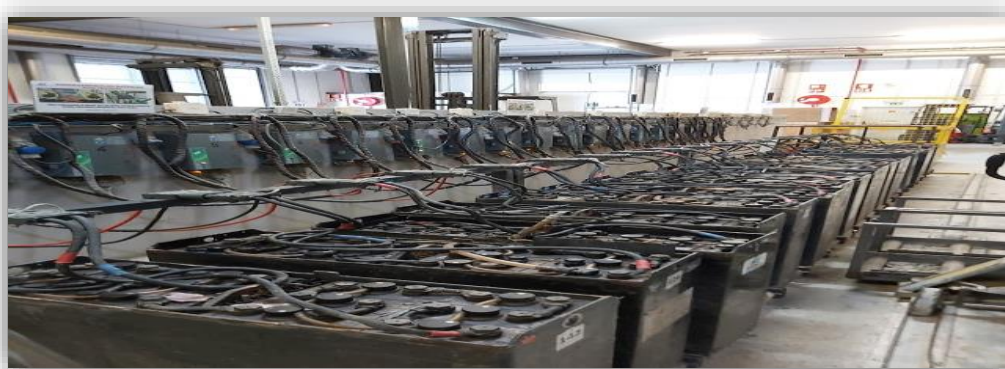
Figura 3 - Sala de troca e carregamento de baterias
