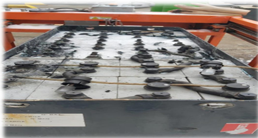
Figura 8 - Bateria acidentada devido curto-circuito
