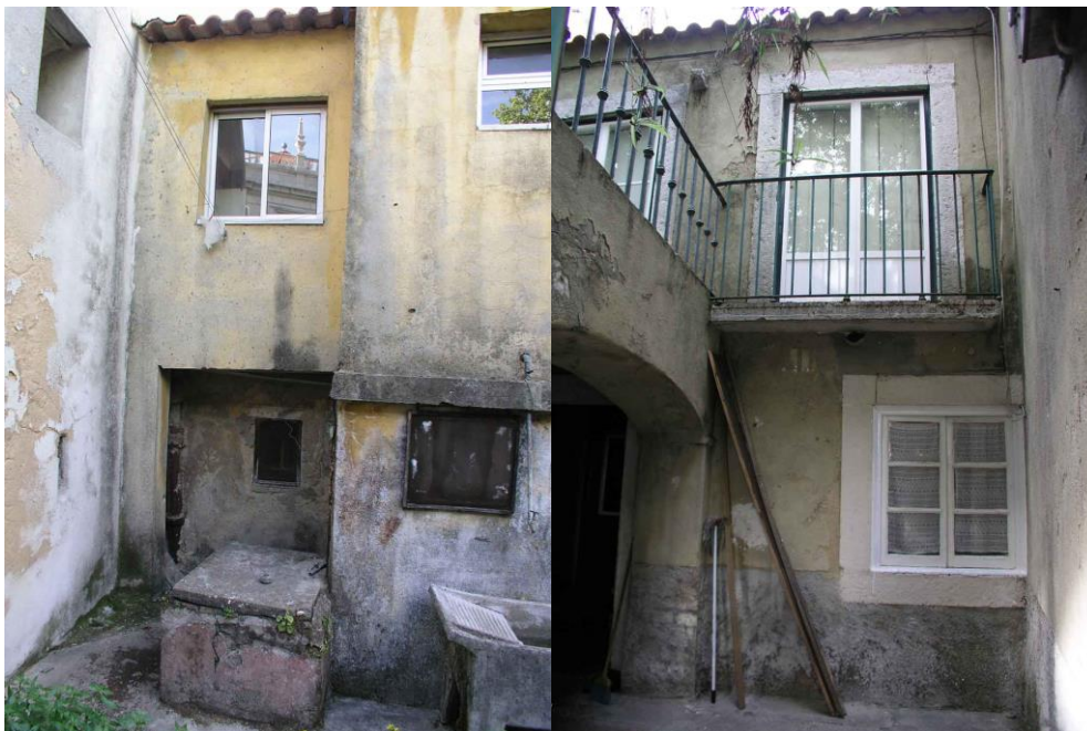
Figura 5.18 - Patologias no conjunto edificado (Fonte: Penim Loureiro, 2007).
