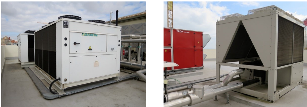
Figuras 29 e 30 – Chillers/Bombas de Calor (Fonte: autor)
