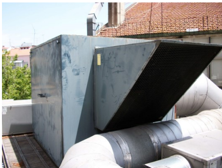
Figura 36 – Ventilador de extração das garagens [23]
