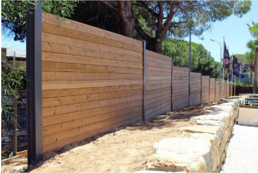
Figura 4.38 – Barreira acústica de madeira (Carmo Wood, 2024)
