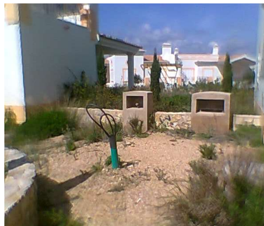
FIGURA 14 – INFRA-ESTRUTURA, TRABALHOS EM FALTA
