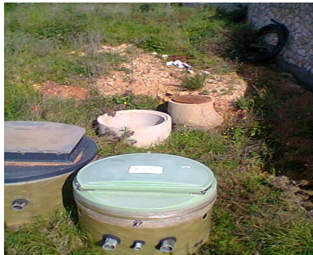
FIGURA 19 - ESTAÇÕES ELEVATÓRIAS COMPACTAS
