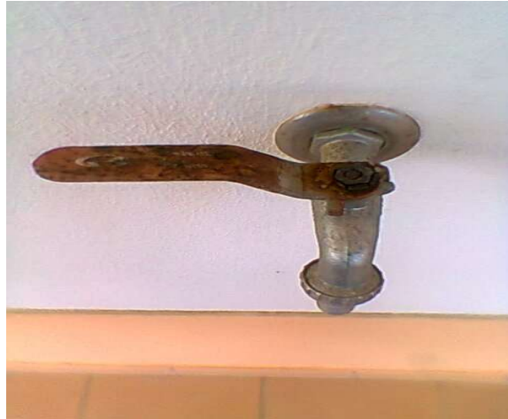
FIGURA 25 - PATOLOGIA TORNEIRA EXTERIOR
