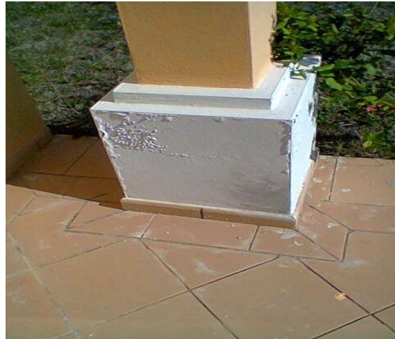
FIGURA 28 - EMPOLAMENTO DE PINTURAS
