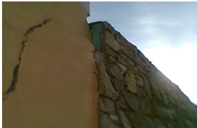
FIGURA 22 – PATOLOGIA NO MURO DE SUPORTE
