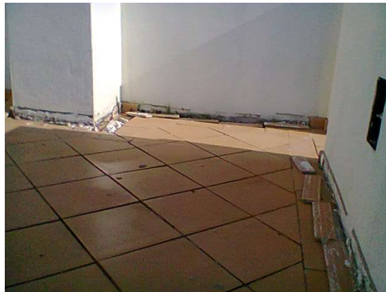
FIGURA 27 - PATOLOGIA TERRAÇOS, COLA RODAPÉS
