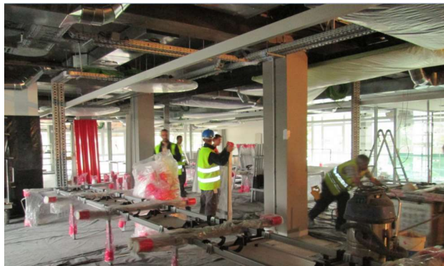
FIGURA 49 - VISTA GERAL DAS INFRA-ESTRUTURAS, PISO 3
