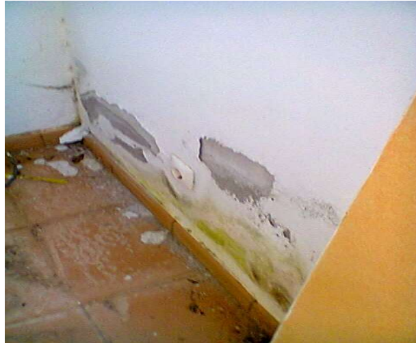
FIGURA 18 - PATOLOGIAS EM REVESTIMENTOS
