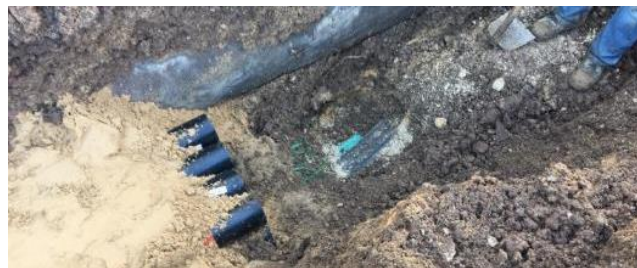
Figura 4-28 – Cabos de Telecomunicações e conduta da EPAL
