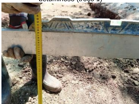
Figura 4-46 – Verificação do fundo de caixa
