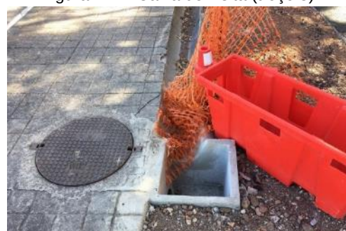
Figura 4-9 – Caixa de passagem (troço 8)
