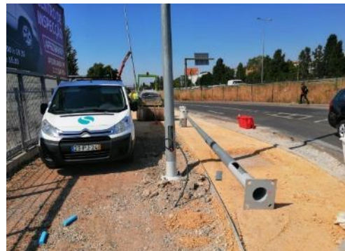
Figura 4-21 – Iluminação pública (troço 7)
