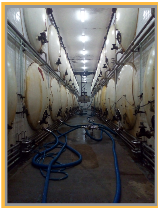
Figura 2.11 Sala de Guarda onde é realizada a maturação de cerveja. Na SCC existem 2 Salas de Guarda em funcionamento para maturação de cerveja Sagres Branca. Cada Sala tem 48 tanques, estando cada 2 tanques ligados internamente perfazendo estes uma capacidade de 1 600 hL.
