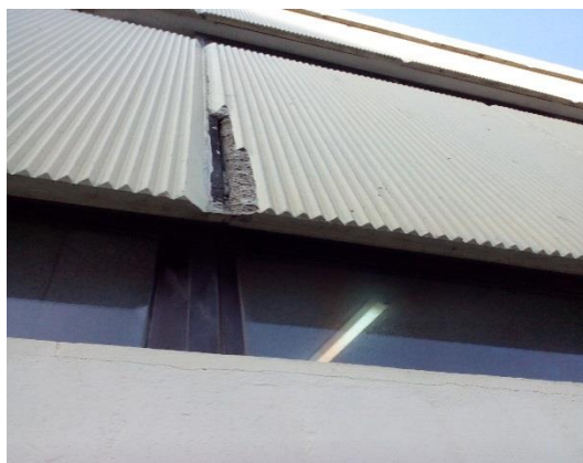
Figura 6 - Painel pré-fabricado deteriorado
