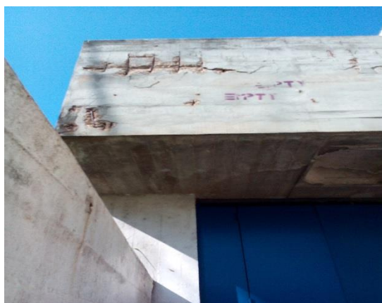
Figura 8 - destacamento do betão e corrosão das armaduras
