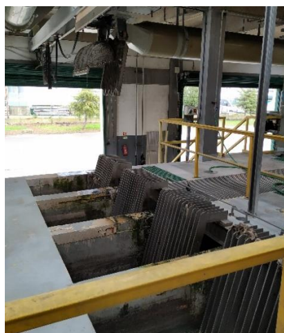
Figura 2.4 - Gradagem automática da ETAR Frielas
